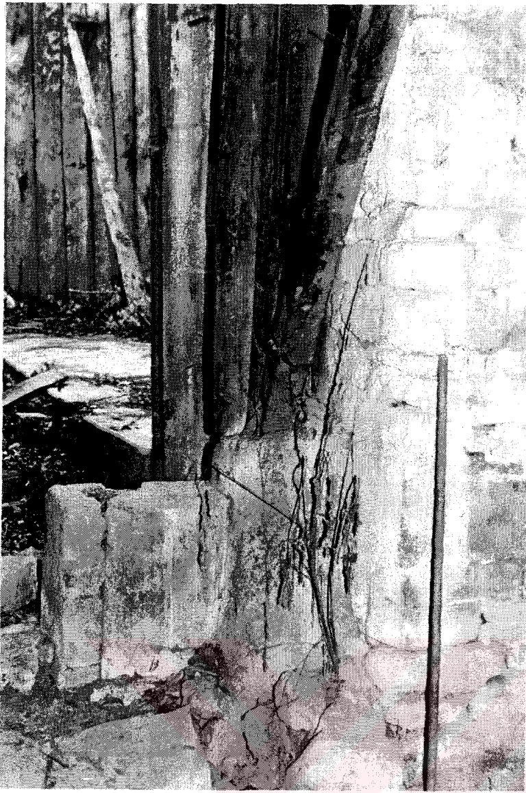
Şekil D49. Selamlık bölümü, sarnıç (Z06) yanı ana taşıyıcı dikme ve taş kaidesi (1999)
