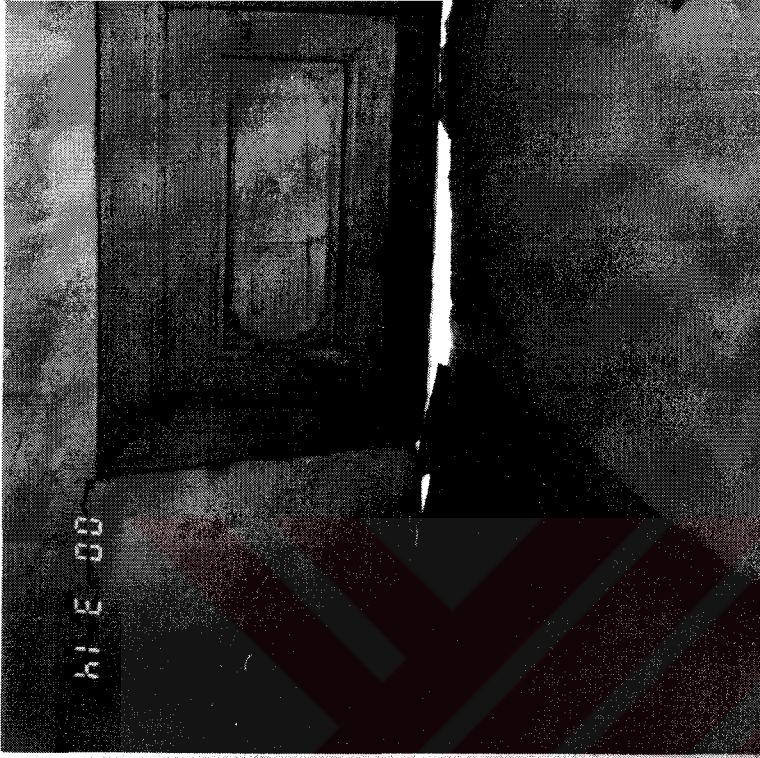
Şekil D161. Selamlık bölümü, 204 mekânı batı duvarı, köşe dolap ve duvar birleşiminde ayrılma (2000)
