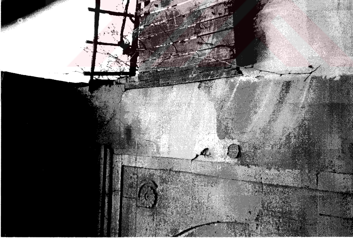
Şekil D15. Selamlık bölümü, giriş cephesi, özgün sıva ve taş taklidi işlemesi (1999)
