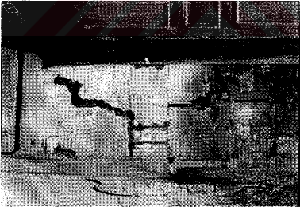
Şekil D179. Selamlık bölümü, avlu girişi ayrılmalar ve çimentolu onarımlar
