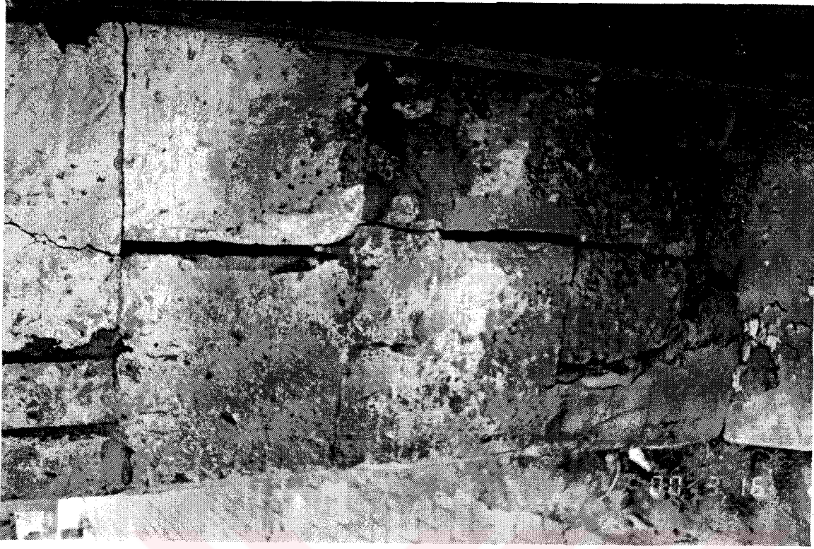
Şekil D180. Selamlık bölümü, avlu girişi taş yüzeyde ayrılma ve çatlaklar
