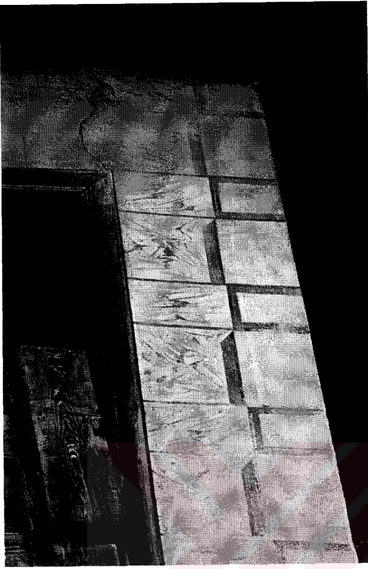
Şekil D197. Selamlık bölümü, köşk oda (202) doğu cephesi kalem işi bezemesi (2000)
