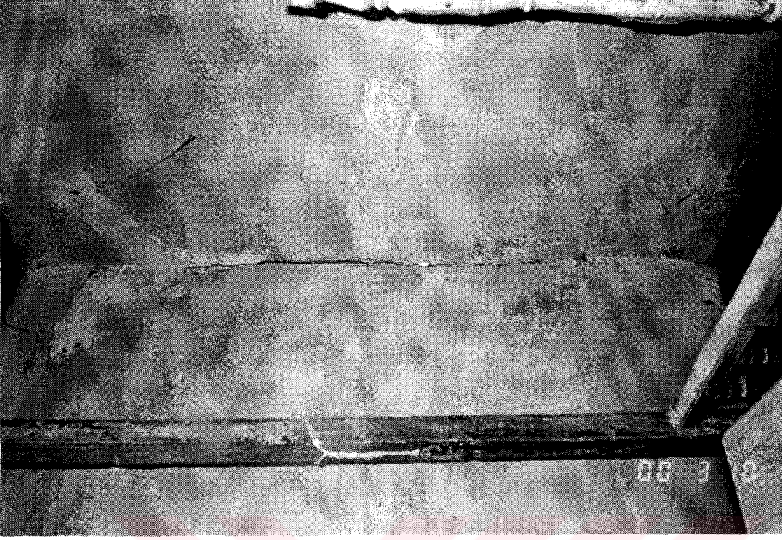
Şekil D182. Selamlık bölümü, ikinci kat sahanlığı kuzey duvarı ile batı duvarı birleşiminde ayrılma
