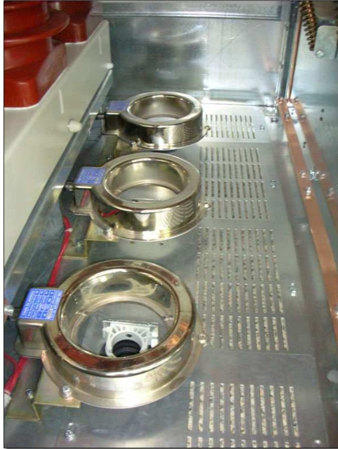
Şekil 4.2: Düşük güçlü akım transformatörlerinin kullanıldığı bir panel
