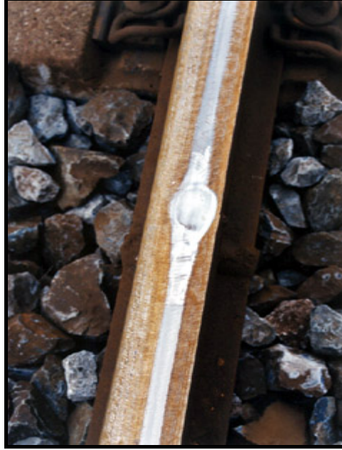
Şekil 4.43: Kaynak Noktalarındaki Problemler
