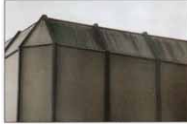
Şekil 5.4 : Aışveriş mağazasının cephesinde kir birikmesi.
