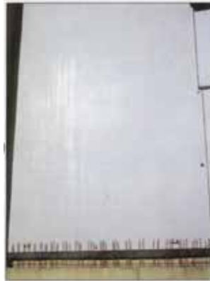
Şekil 5.2 : Yanlış temizleme ile akrilik kaplı son katmana sahip tabakanın hasarı.
