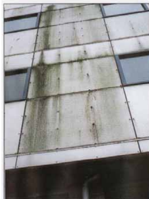
Şekil 5.3 : Apartman bloğu cephesinde kir birikmesi.
