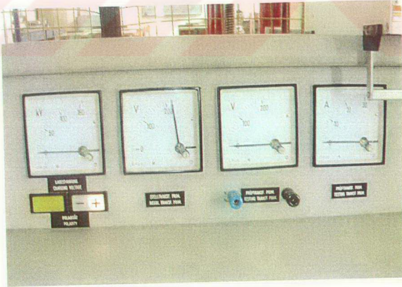
Şekil C.15 Kumanda masasındaki ampermetre ve voltmetreler
