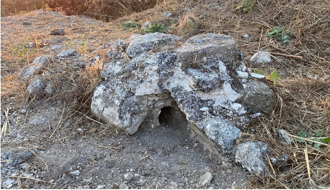
Şekil 3.8 : Kule 2 duvarı üst dolgusunda bulunan kırık sütun tamburu ve hatıl boşluğu (Kaymak, 2022)
