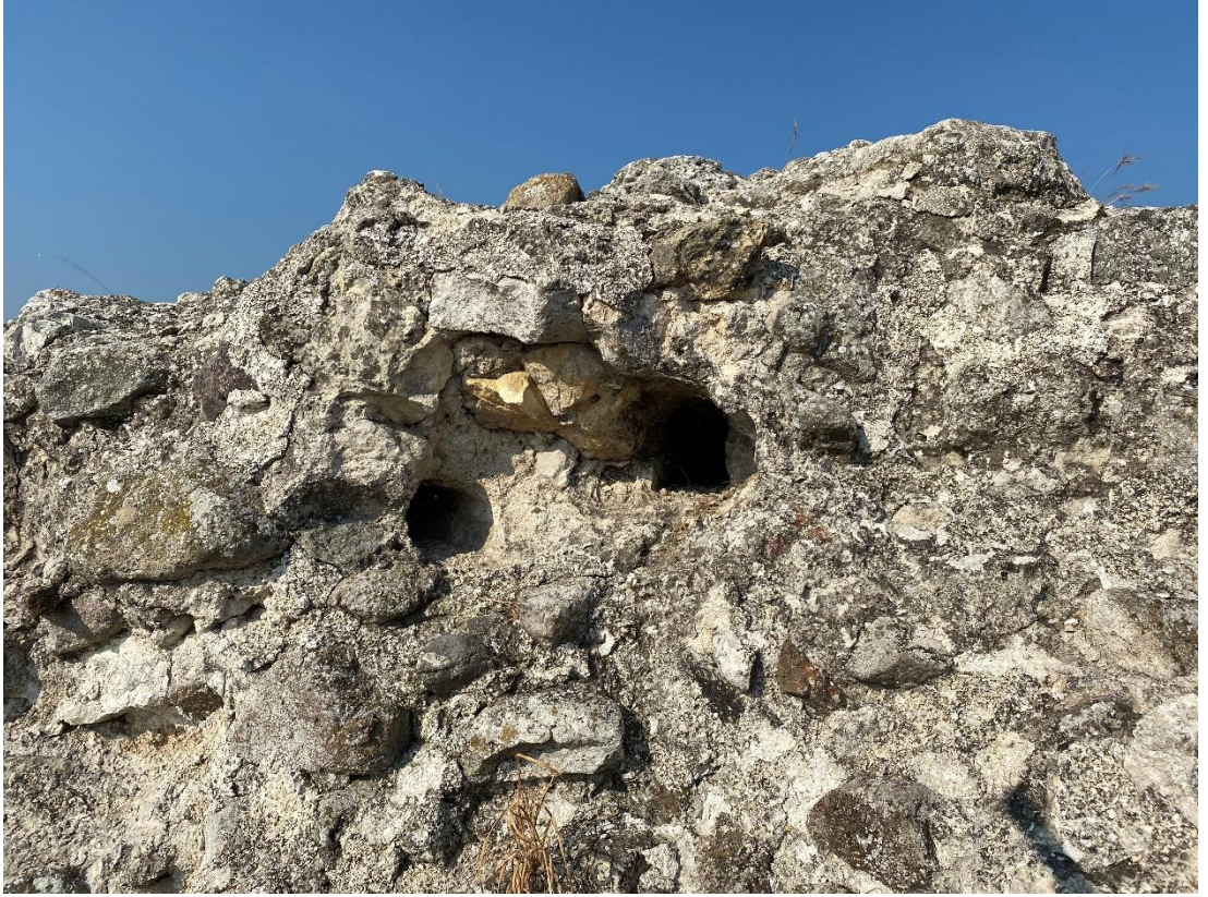
Şekil C.8 : Kule 5 dolgusunun doğu yüzeyindeki hatıl boşlukları (Kaymak, 2022)
