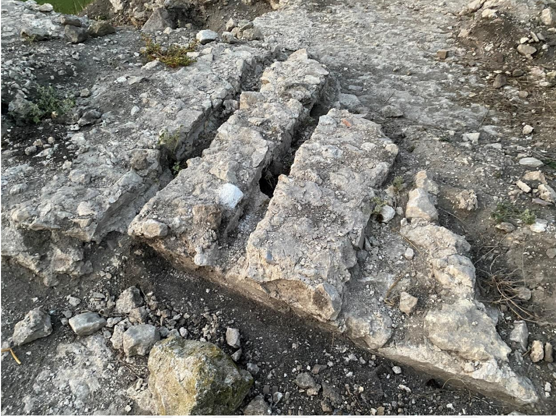
Şekil C.5 : Kule 4 duvarı dolgu yüzeyindeki hatıl izi ve boşlukları (Kaymak, 2022)
