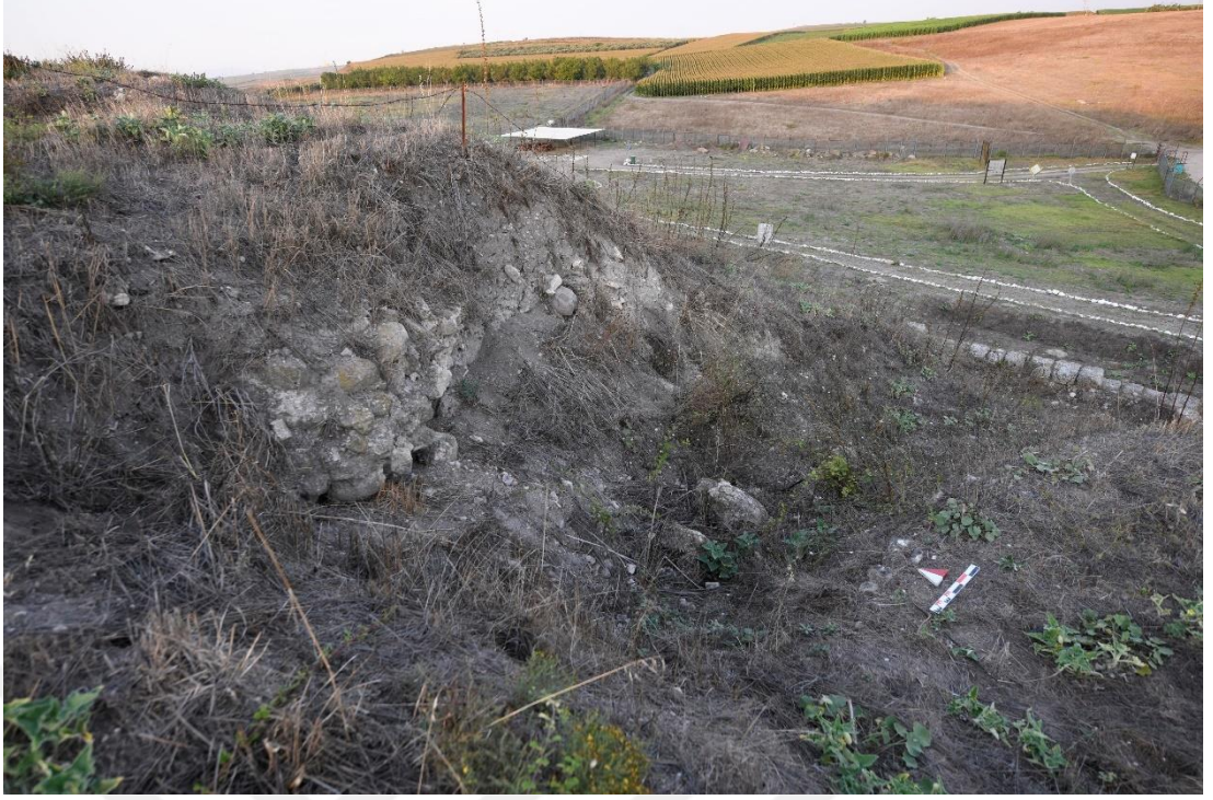
Şekil 3.15 : Toprak kayması sonucu açığa çıkan Kule 3- Kule 4 Duvarı'na kuzeybatıdan bakış (Daskyleion Kazı Arşivi, 2022)
