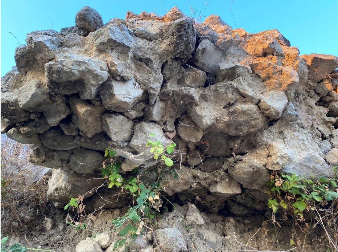
Şekil C.2 : Toprak kayması sonucu açığa çıkan Kule 2 temel altı (Kaymak, 2022)
