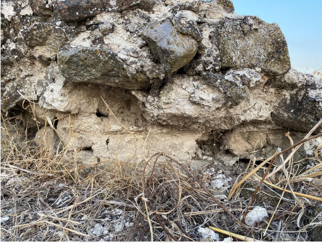
Şekil 3.11 : Kule 2- Kule 3 Duvarı moloz dolgu yüzeyindeki hatıl izi ve boşluğu (Kaymak, 2023)
