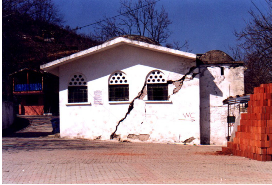
Şekil 4.7 Örçün Fayı üzerinde gözlenen hareket nedeniyle Sultanbaba Türbesi civarındaki hamamda meydana gelen hasar.
