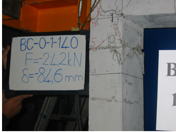
Şelil 4.25 Birinci Kat Sol Kolon Üst Noktasında Meydana Gelen Kesme Çatlakları
