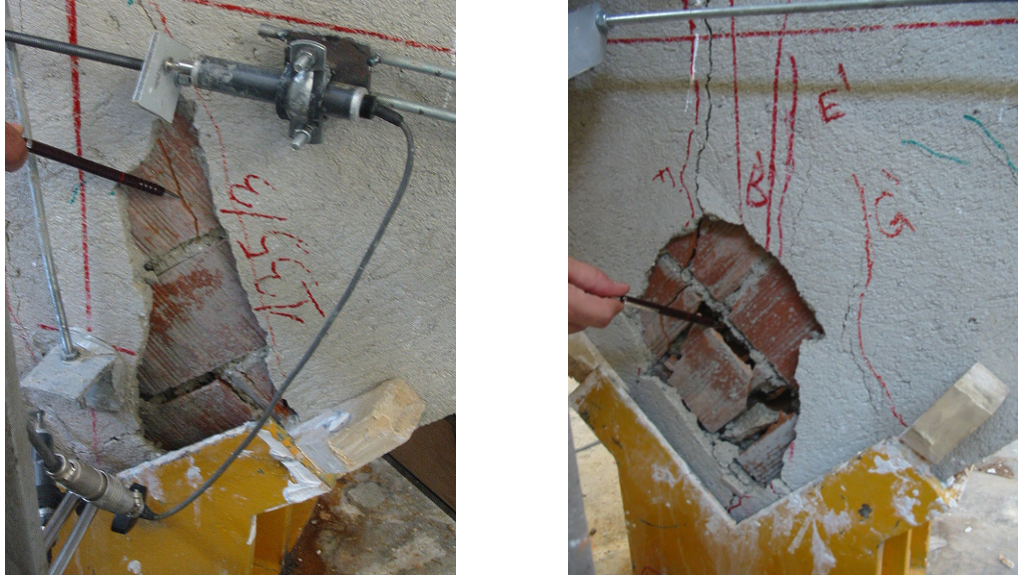
Şekil 4.19 Tuğlalarda Meydana Gelen Çatlaklar ve Göçme Şekli
