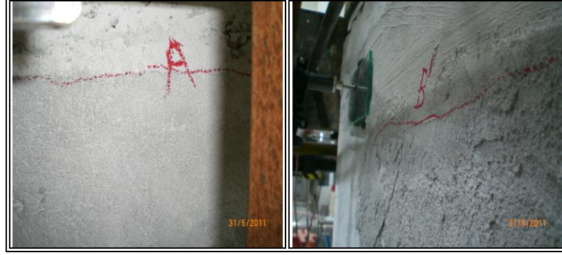
Şekil 3.37: Dolgu duvarlı çerçeve numunesinde 2. ve 3. çevrimlerde oluşan ilk çatlaklar.
