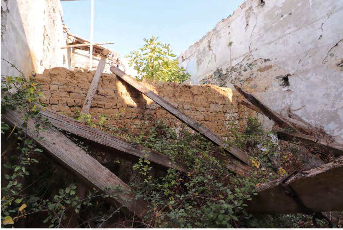
Şekil 4.24: Y02-02'deki kerpiç duvar ve ahşap elemanlar (Mustafa Akçaöz, 2019).
