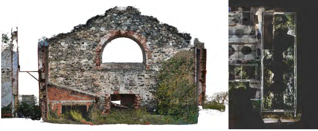
Şekil 4.47: Beden duvarlarındaki deformasyon (Y01).
