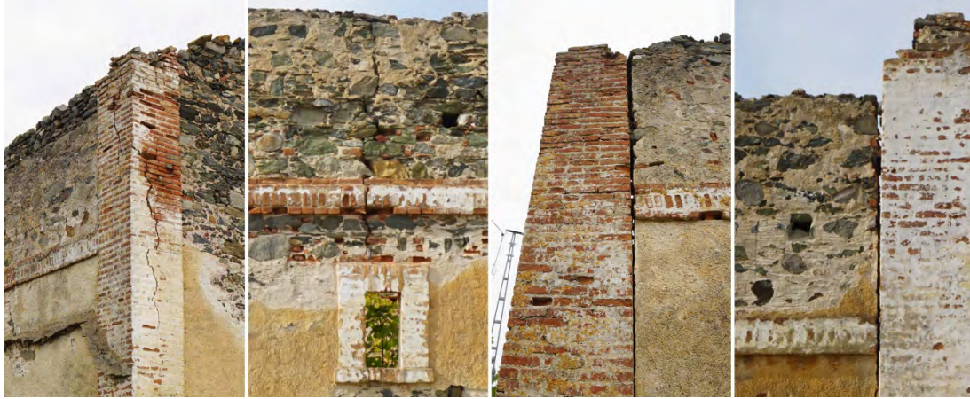
Şekil 4.48: Yapısal çatlaklar ve ayrılmalar (Y01).
