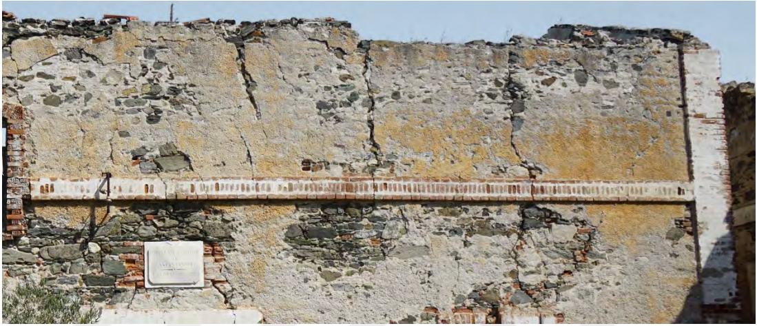
Şekil 4.53: Batı cephesinde yapısal çatlaklar (Y02).
