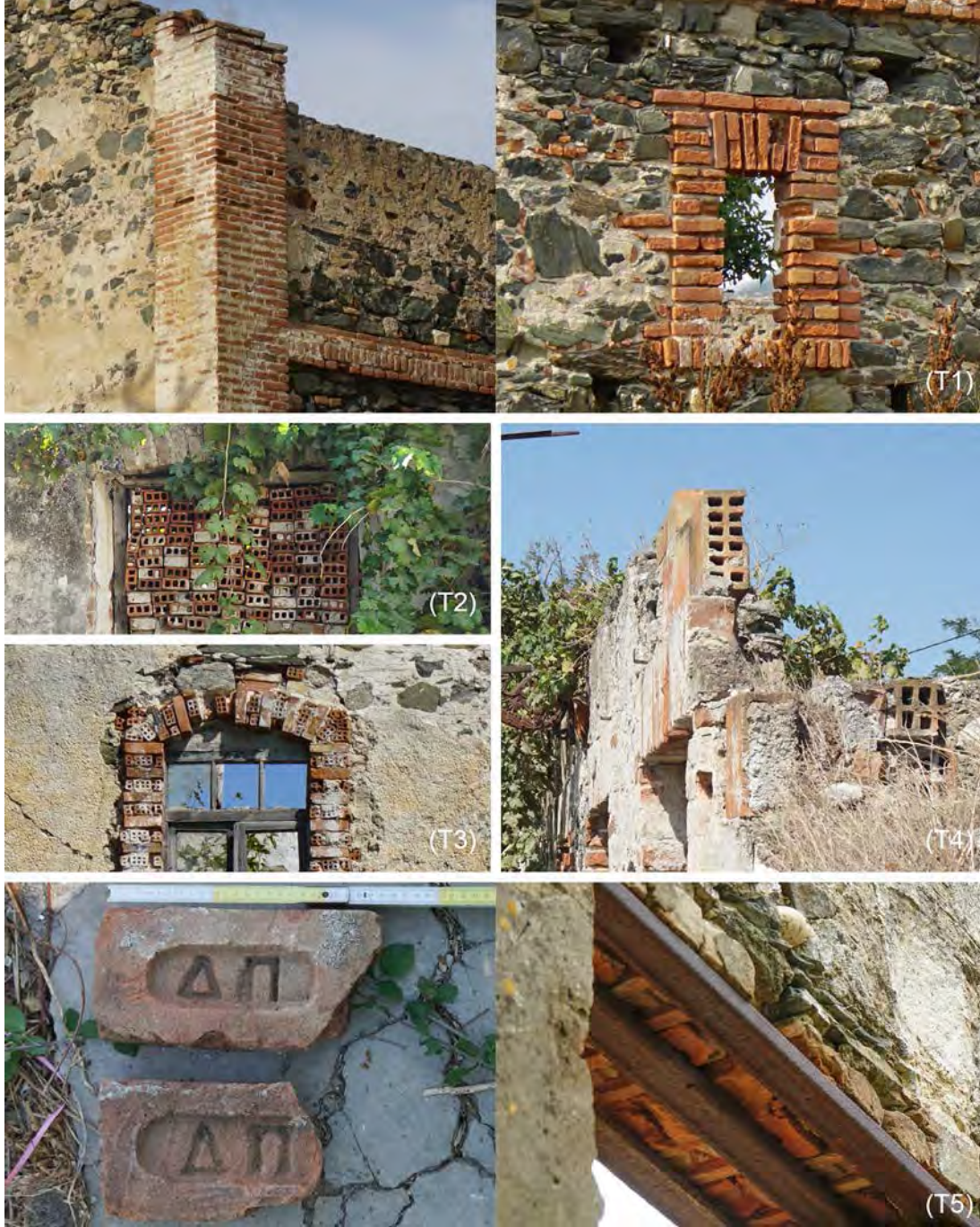
Şekil 4.39: Tuğla tipleri (T1-T5).
