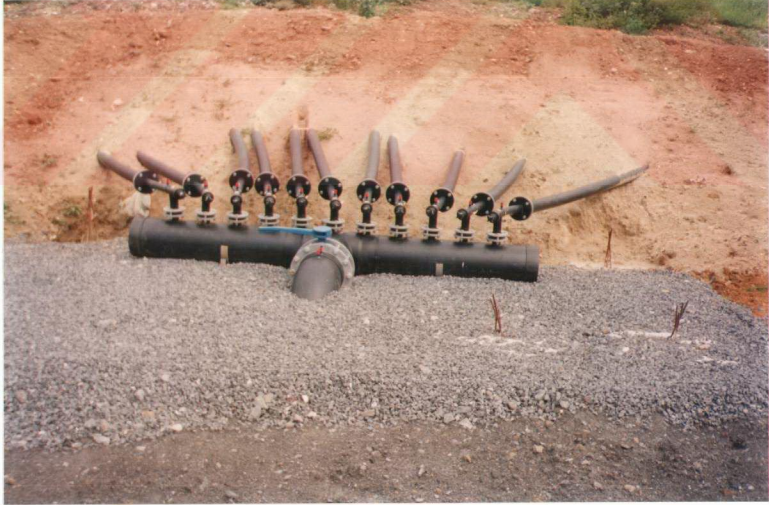
Şekil B.2 Kemberburgaz Açık Depo Sahası Kollektör Merkezlerinden Birinin Görünümü
