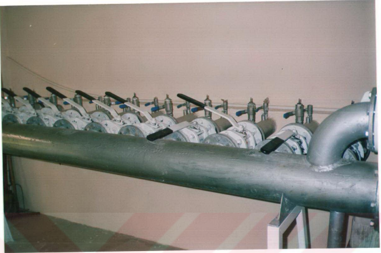
Şekil D.3 Yakacık Açık Depo Sahası Gaz Toplama Merkezinin Görünümü
