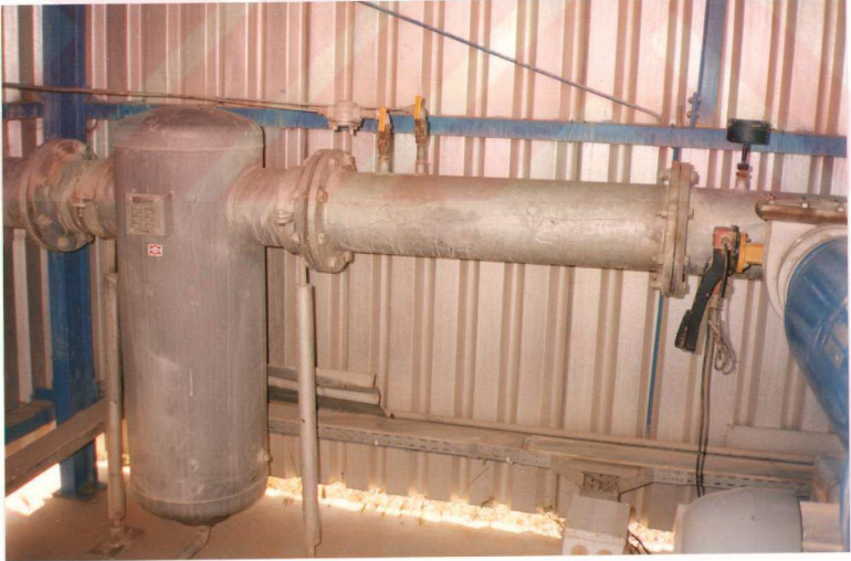
Şekil C.4 Harmandalı Düzenli Depolama Alanı Kondensat Tutucunun Görünümü
