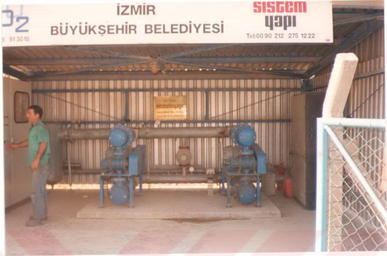
Şekil C.5 Harmandalı Düzenli Depolama Alanı Blöverlarının Görünümü
