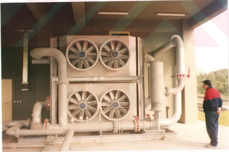
Şekil B.4 Kemirburgaz Açık Depo Sahası Gaz Soğutucunun Görünümü
