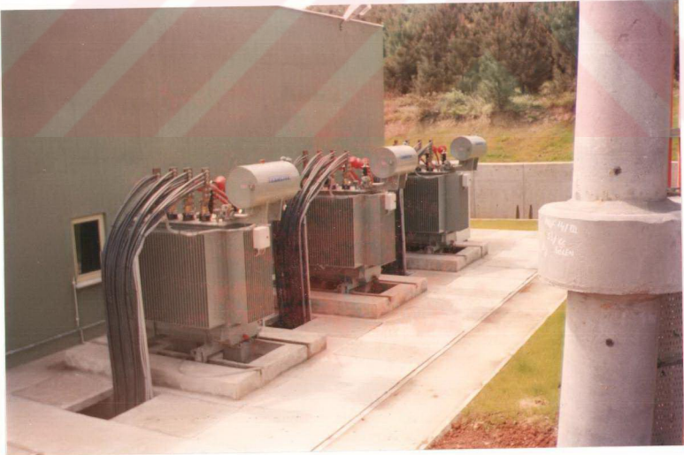
Şekil B.8 Kemirburgaz Açık Depo Sahası Trafoların Görünümü
