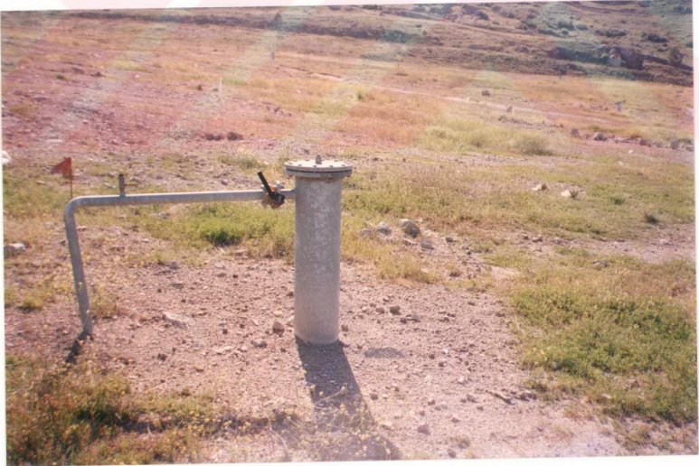
Şekil C.2 Harmandalı Düzenli Depolama Alanı Düşey Gaz Kuyusunun Görünümü
