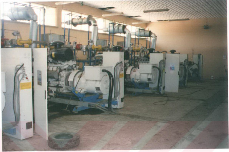
Şekil A.7 Demirtaş Açık Depo Sahası Jeneratörlerinin Görünümü
