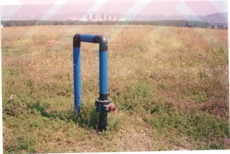
Şekil A.2 Demirtaş Açık Depo Sahası Düşey Gaz Kuyusunun Görünümü
