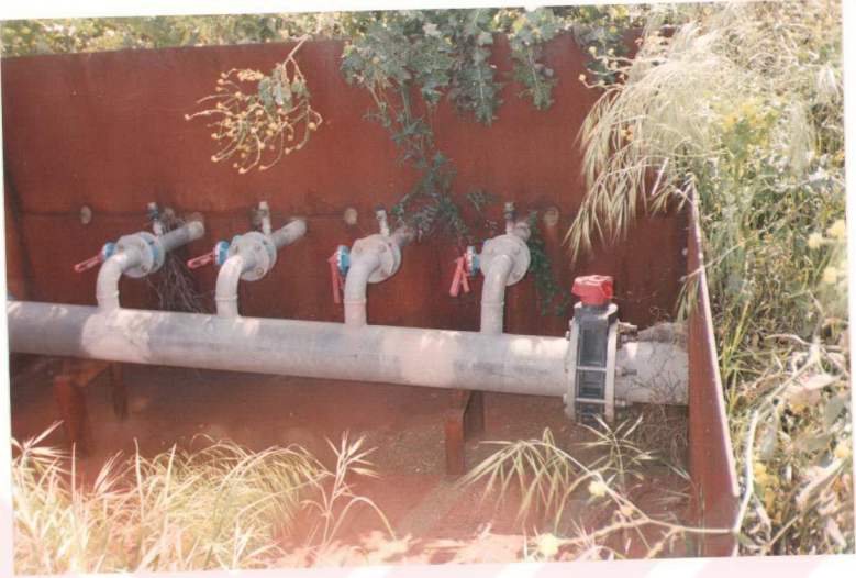
Şekil A.3 Demirtaş Açık Depo Sahası'nın Kollektör Merkezinin Görünümü
