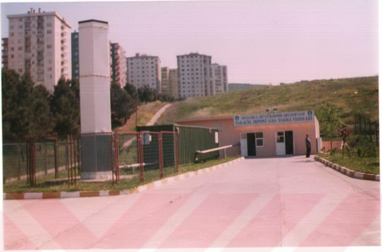
Şekil D.1 Yakacak Açık Depo Sahası Gaz Yakma Tesisinin Genel Görünümü
