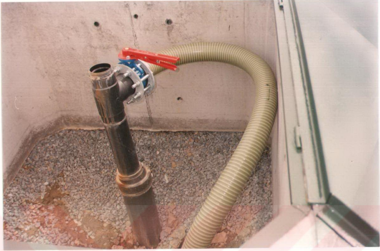
Şekil B.1 Kemberburgaz Açık Depo Sahası Düşey Gaz Kuyusunun Görünümü
