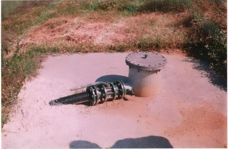
Şekil D.2 Yakacak Açık Depo Sahası Gaz Kuyusunun Görünümü
