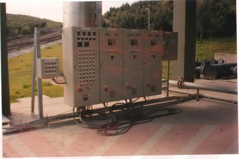
Şekil B.7 Kemirburgaz Açık Depo Sahası Blower Ve Gaz Yakıcı Kontrol Panosu
