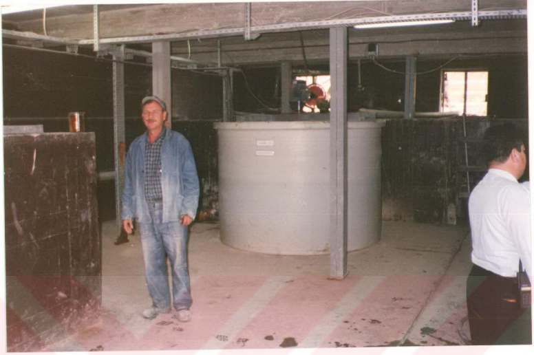
Şekil C.9 Harmandalı Düzenli Depolama Alanı Sızıntı Suyu Kimyasal Arıtma Tesisinin Görünümü
