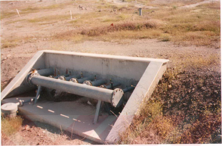
Şekil C.3 Harmandalı Düzenli Depolama Alanı Gaz Toplama Merkezinin Görünümü
