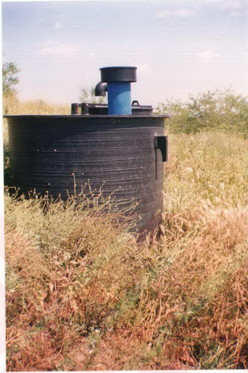
Şekil A.5 Demirtaş Açık Depo Sahası Kondensat Tutucunun Genel Görünümü
