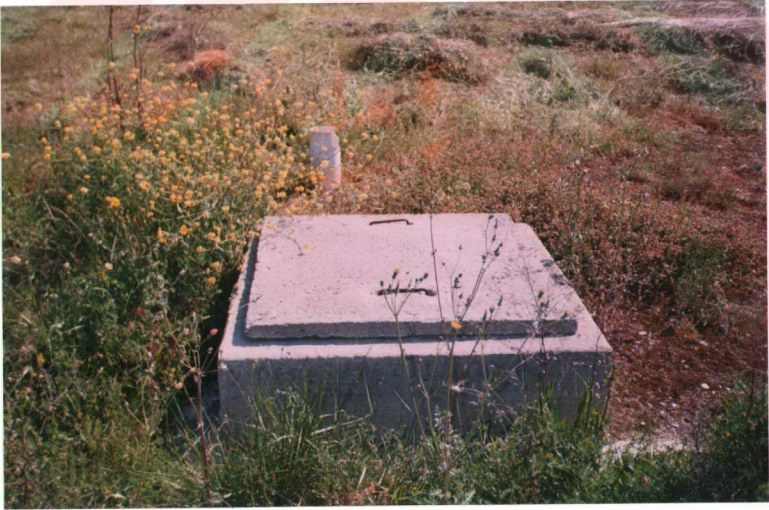
Şekil D.9 Yakacık Açık Depo Sahası Sızıntı Suyu Toplama Havuzunun Görünümü
