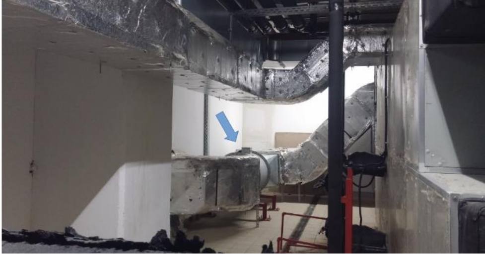
Şekil 4.11 : 34.kattaki tesisat daireesinde basınçlandırma fanı ve basınçlandırma kanalları.
