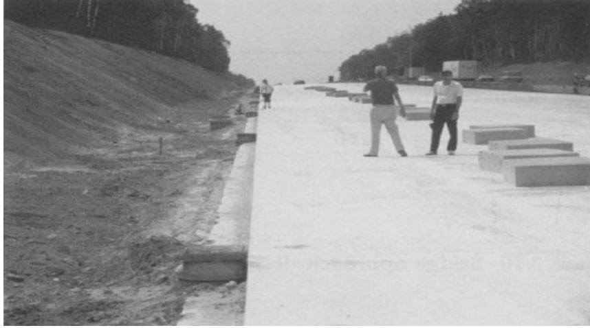
Şekil 4.14: Berlin'in güneyinde A10 otoyolu inşa kesiminde; plak kenarında zayıf beton temel altındaki boyuna kanala ve sol tarafta görülen rögarlara bağlı olan su toplama hazneleri. [4]
