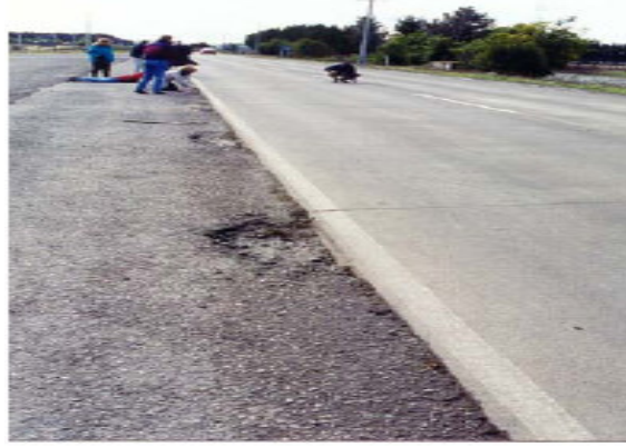
Şekil 7.30: Asfalt banket boyunca her bir enine derz boyunca görülen erozyon. Ağır taşıtlar derz üzerinden geçtiğinde plak altında bulunan su büyük bir hızla dışarıya doğru çıkmak için zorlanır. [12]
