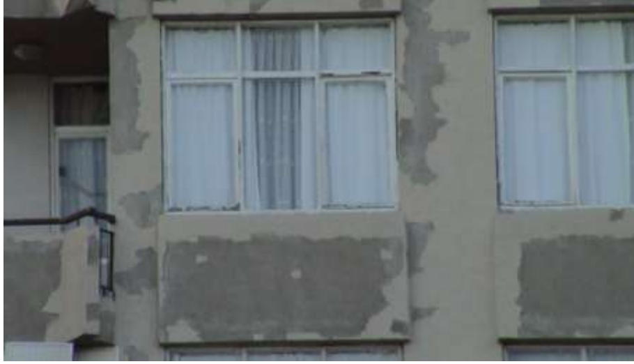
Şekil 4.17 Rüzgarla itilen yağmur damlalarının ve havada bulunan nem etkisinde oluşan ince sıva (hazır sıva) dökülmeleri.
