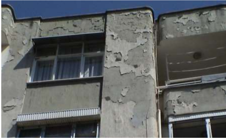
Şekil 4.26 Harpuştanın yanlış olmasına bağlı olarak yağmur damlalarının dış duvarda yarattığı hasarlar.
