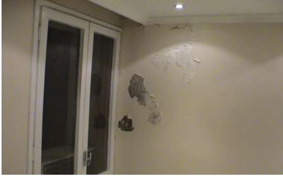
Şekil 4.11 Gzli yoğunlaşma suyu ve duvar yüzeyinde terlenme sonucu oluşan suyun neden olduğu kabarması ve dökülmesi.
