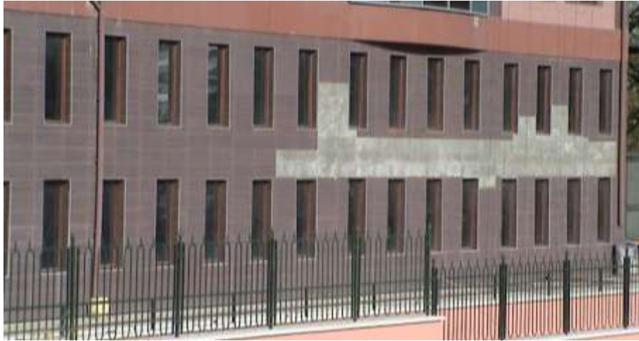
Şekil 4.18 Kapsama altında oluşan gizli yoğuşma sonucunda yapıştırma harcıyla tespit edilen seramik kaplamanın dökülmesi.
