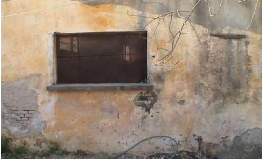
Şekil 4.10 Rüzgarla gelen yağmur damlaları, kapilarite yoluyla duvar bünyesine nüfuz eden zemin suları etkisinde sıva dökülmeleri, çiçeklenme, kabarmalar ve dökülmeler.
