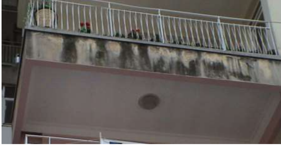
Şekil 4.25 Damlalık ayrıntısının yanlış olması nedeniyle, suyun bina cephesinde oluşturduğu istenmeyen görüntü ve hasarlar.
