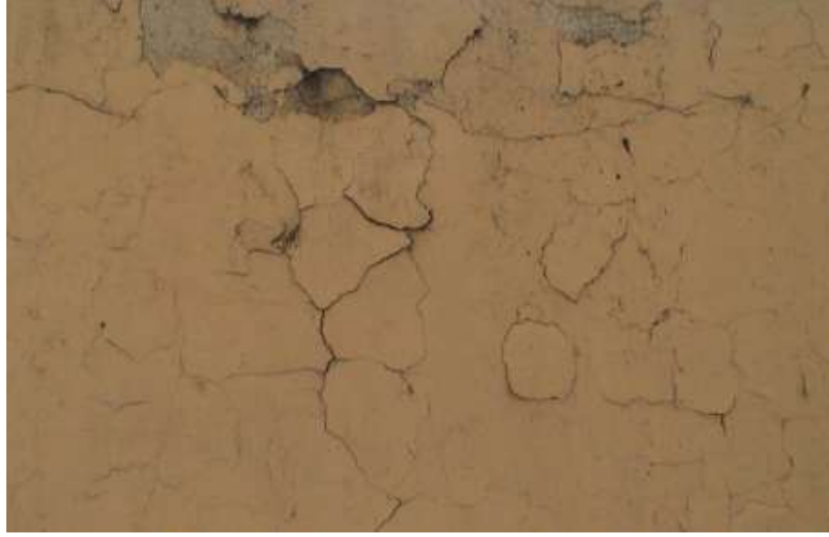
Şekil 4.13 Kaplama bileşeni içinde oluşan çatlaklar, kabarma ve dökülmeler.
