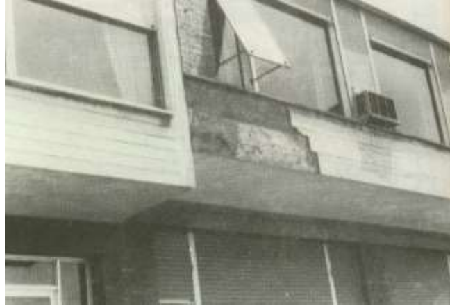
Şekil 3.3 Dış duvara nüfuz eden suyun donması sonucunda dış kaplama bileşeninde oluşan ve ileride onarılmayı bekleyen düşme ve kırılma [12].
