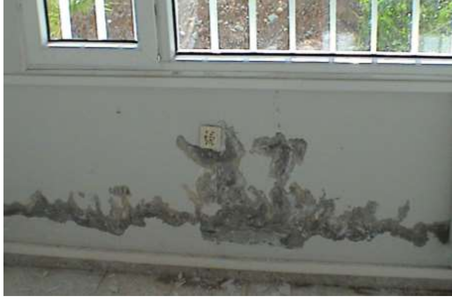
Şekil 4.9 Yoğuşma nedeniyle oluşan suyun yarattığı hasar.
