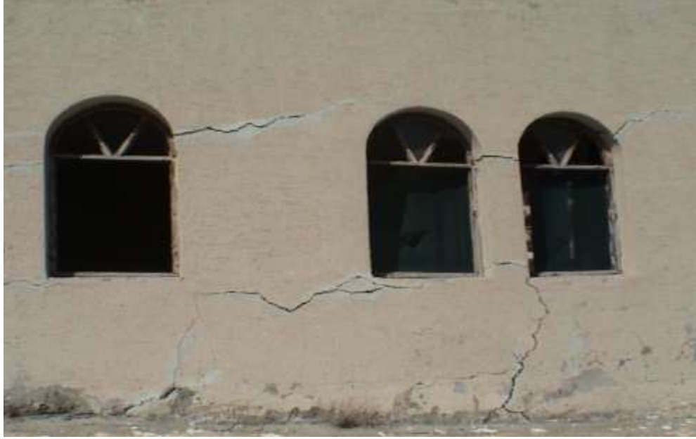
Şekil 4.15 Bina nın oturdu ğu ze m in i çerisindeki yağış sularına ba ğlı hareketler etki sinde duvar da ol uş an çatla klar.
