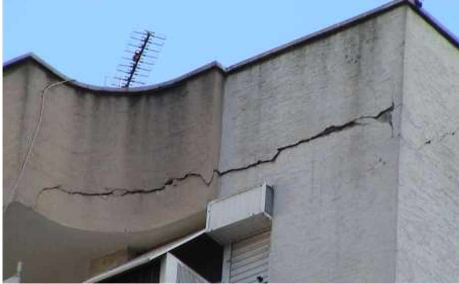
Şekil 4.23 İki farklı ürünün ara kesitinde oluşan ayrılma, çatlama, dökülme.
