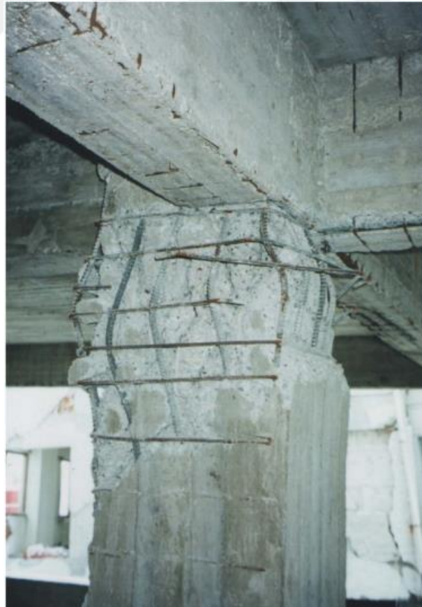
Şekil A.2 : Lifli polimer ile sargılanmamış kolonlara ait deney sonunda gözlenen hasar durumu (İlki ve diğ., 2008).
