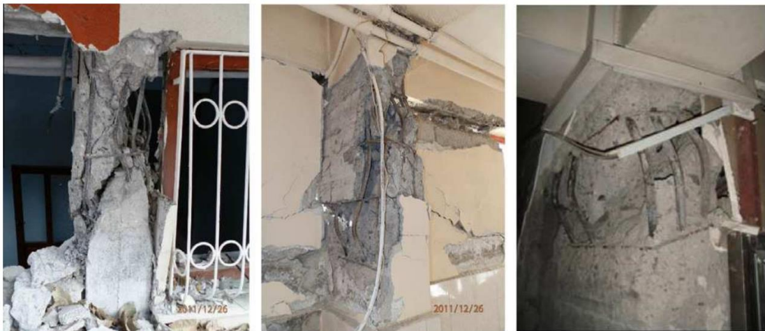
Şekil 2.1 : 2011 Van Depreminde yetersiz süneklik sebebiyle hasar görmüş kolonlar (Tapan ve diğ., 2013).
