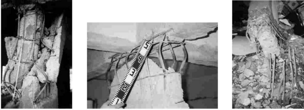
Şekil 1.1 : Yetersiz enine donatı, düşük beton dayanımı ve yetersiz detaylandırma gibi sebeplerle hasar görmüş kolonlar (İlki ve diğ., 2008).
