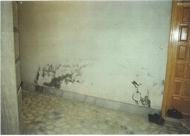
Şekil 5.25: Orta kalitede bir kooperatif yapısına ait koridor duvarının arkasındaki ıslak hacim tesisatlarında oluşan arızalar sebebi ile duvarların ıslanması ve kaplamasındaki dökülmeler görülmektedir.
