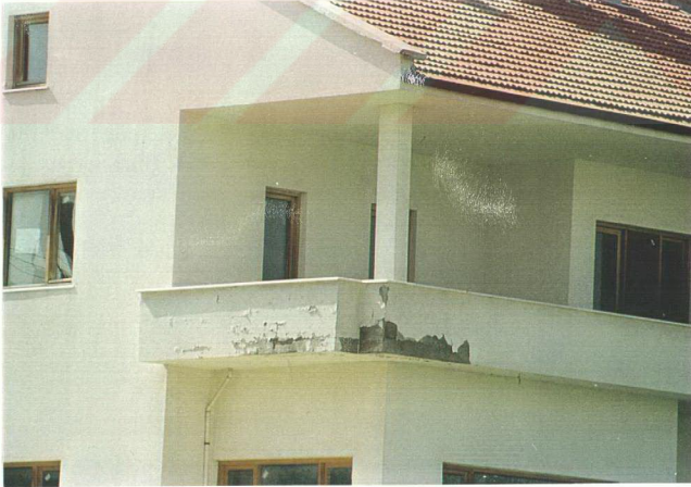
Şekil 5.14: Yapılarda ortaya çıkan problemlerin ihmal edilmesi veya bakımın geciktirilmesi, ıslanmış balkon parapeti olarak sonuçlanabilir.
