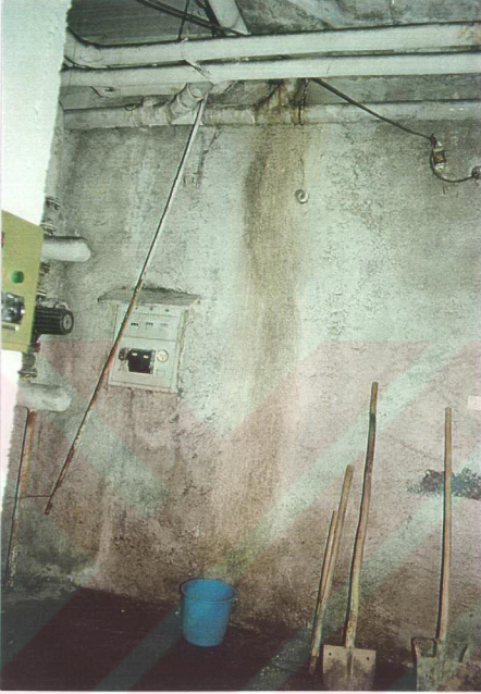
Şekil 5.46: Pis su tesisatlarının bodrum katlarda toplanması ile tıkanmalar çoğalmakta ve sızırdırmalar duvarlarda kirliliğe sebep olmaktadır.
