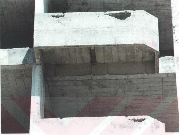
Şekil 5.17: Hızlı hazır beton ile vibratöründe yetersiz olduğu durumlarda, taşıyıcı sistemde tehlikeli boşluklar oluşabilir.
