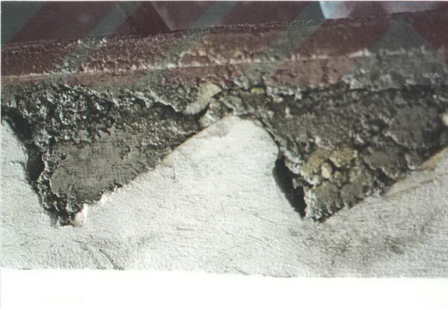
Şekil 5.30: Yukarıdaki aynı merdivene (prefabrik suni mozaik taş) ait damlalık detayının yanlış yapım tekniği yandan görülmektedir.
