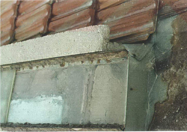
Şekil 5.35: Yanlış yapım tekniği ile inşa edilmiş merdiven evi ışıklığı detayı yağmur suyunu içeri sızdırabilir; ve kalitesi çinko etek paslanmış durumda.
