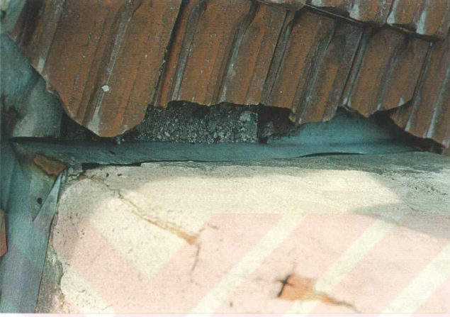
Şekil 5.34: Çatıda baca gövdesinde yapılan çinko etekte görülen kötü işçilik bacanın ve çatının ıslanmasına sebep olmaktadır.
