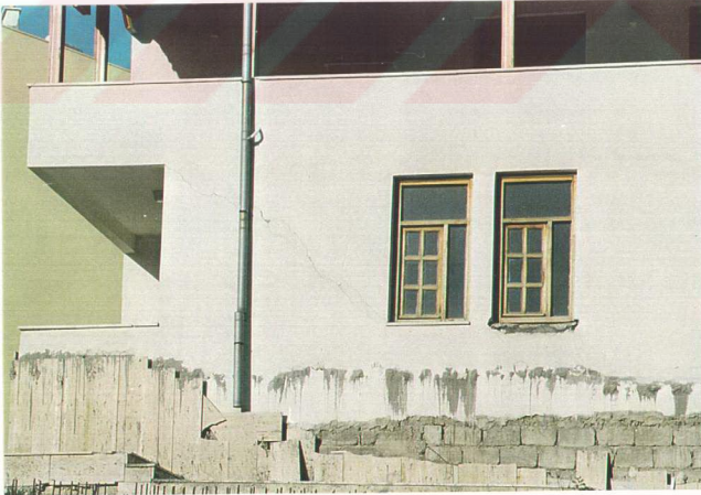
Şekil 5.16: Yanlış veya yapılmamış zemin hesaplamaları sonucunda, zemin hareketi yapıda ciddi kırılmalara veya çatlaklara sebep olabilir.
