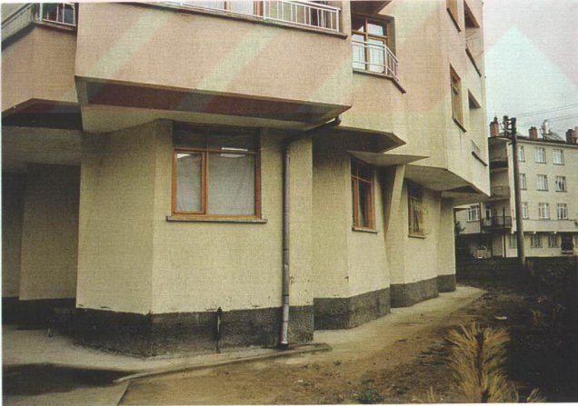
Şekil 5.2: Tasarım hatası, yapı cephesine kötü görüntü olarak yansımaları görülmektedir.
