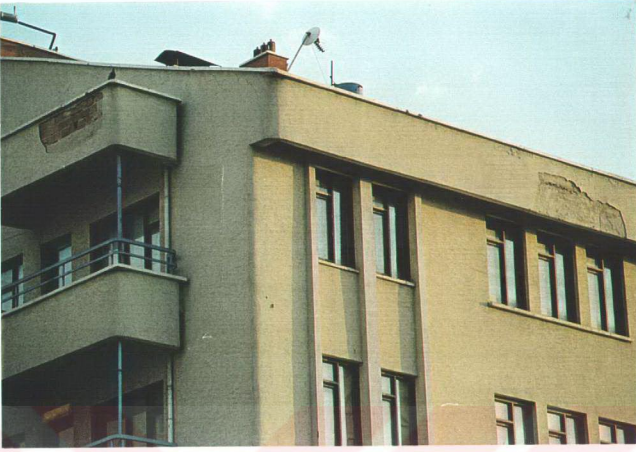
Şekil 5.4: Yanlış tasarım, malzeme seçimi ve de kötü işçilik sonucu, gizli çatı deresi ve balkon üstü terasında fiziksel hasara sebep olmaktadır.
