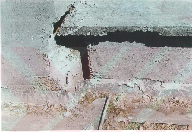
Şekil 5.11: Çatıda baca ve parapet eteği teneke işçiliğinin kötü uygulama örneği.
