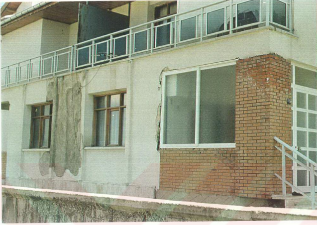
Şekil 5.13: Yanlış bina bakımı sebebiyle ıslanmaların hasara yol açtığı; yine, giriş terasını yanlış bir müdahale ile kapatma oldukça dikkat çekicidir.
