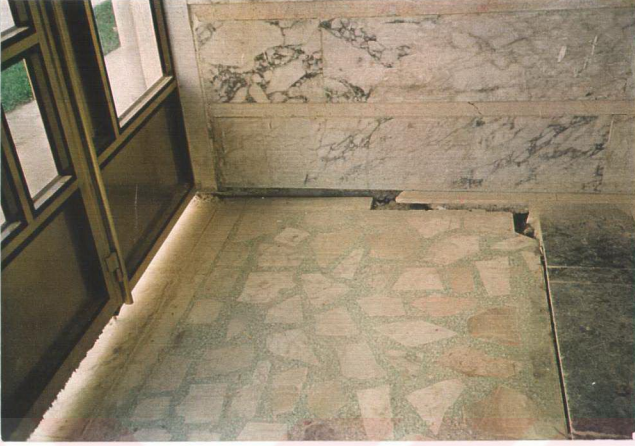
Şekil 5.41: Şekil 5.36'da giriş kapısının konsolun hizasına çekilmesi ve bina temelini dışına çıkılması ile, bu kısmın zemininde oturmaların devam etmesi döşemede çökmelere sebep olmaktadır.
