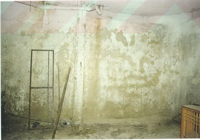
Şekil 5.20: Yer altı veya zemin suyuna karşı yetersiz drenaj ve yalıtımdan dolayı bodrum iç duvar yüzeyindeki sıva dökülmeleri görülmektedir.
