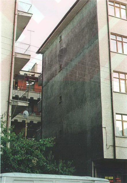
Şekil 5.8: Yanlış imar tadilatı bitişik nizamla göre inşa edilmiş yapının sağır cephesinin görünür halde kalmasına sebep olmuştur.
