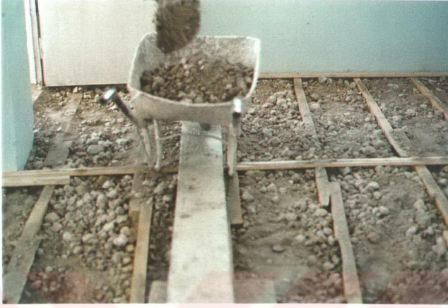
Şekil 5.49: Bodrumlu zemin kat ahşap döşemenin kadron araları öğütülmemiş bims kumu ile doldurulmasıyla ekonomik fakat yetersiz ısı yalıtımı uygulaması görülmektedir.
