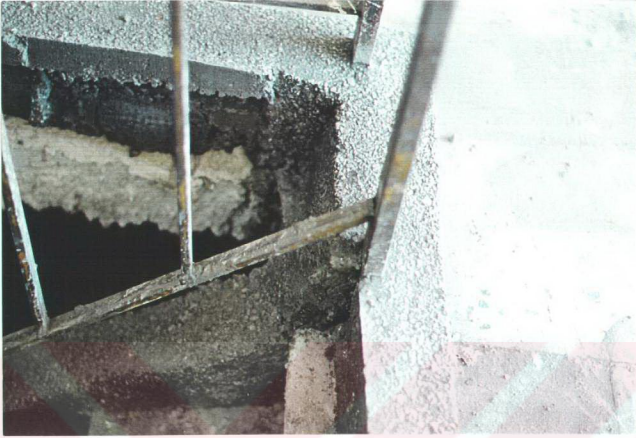
Şekil 5.29: Düşük kalitede bir kooperatif yapısına ait kötü işçilik ve yapım tekniği ile yapılmakta olan merdiven kenar damlalık detayı görülmektedir.
