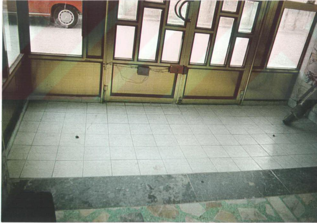
Şekil 5.42: Şekil 5.36'da giriş kapısının konsolun hizasına çekilmesi ve bina temelini dışına çıkılması ile, zemininde oturmaların devam ettiği ve bu sebeple yapılan tamiratın uyumsuzluğu görülmektedir.
