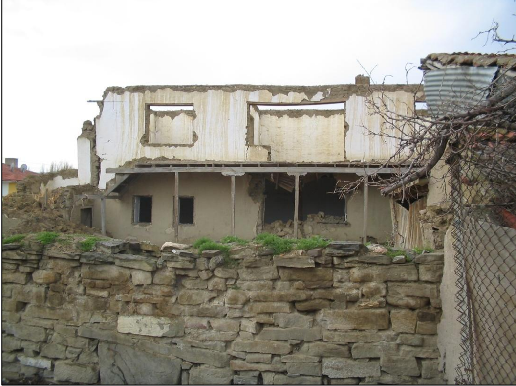
Şekil 1.4c: Bâla ilçesinde M_L=5.6 ve 5.5 olan 2007 yılı depremlerinde hasar görmüş kerpiç evlerin görünümü (Çubuk ve Taymaz, 2009a, b).
