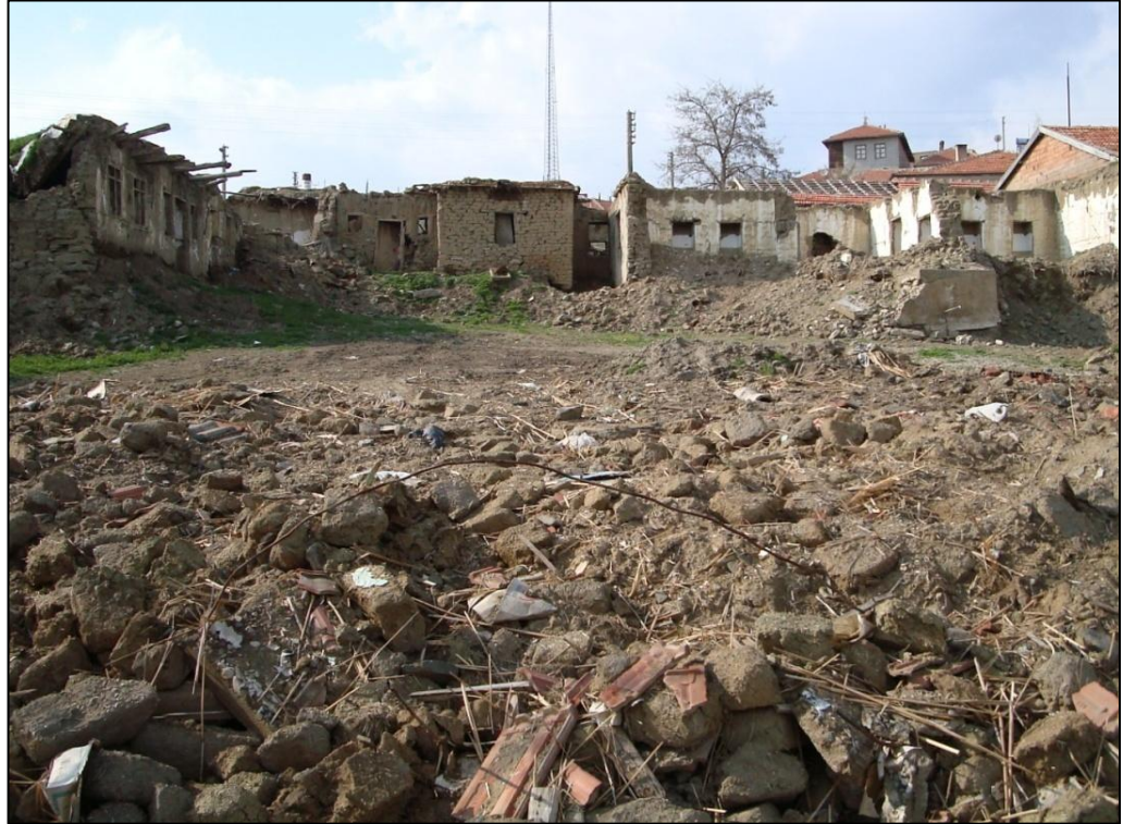
Şekil 1.4a: Bâla ilçesinde M_L=5.6 ve 5.5 olan 2007 yılı depremlerinde hasar görmüş kerpiç evler (Çubuk ve Taymaz, 2009a, b).
