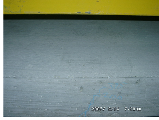
Şekil 6.19: P15 Plağı 3A Çatlağı
