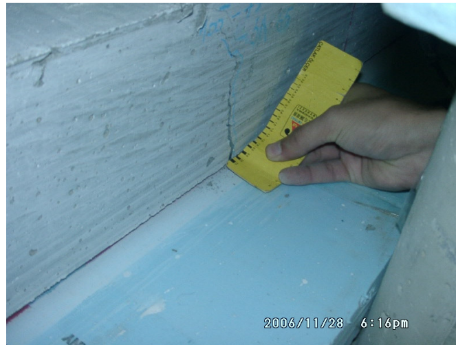
Şekil 6.12: P14 Plağı 1B Çatlağı
