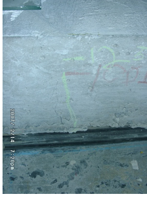
Şekil 6.18: P15 Plağı 1A Çatlağı
