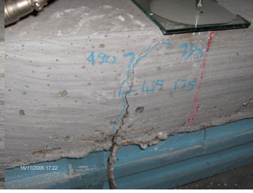
Şekil 6.6: P13 Plağı 4A Çatlağı
