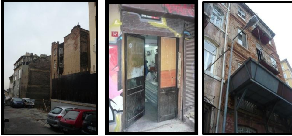
Şekil 4.8 : Uygulama alanında kaybedilen ve risk altındaki tescilli yapı örnekleri 2011 (A. Eskici Özten).
