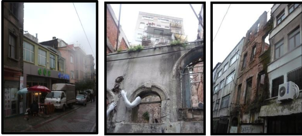
Şekil 4.9 : Uygulama alanında kaybedilen ve risk altındaki tescilli yapı örnekleri 2011 (A. Eskici Özten).
