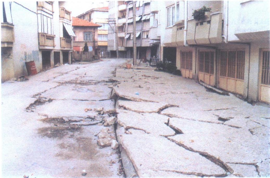
Şekil 3.20. Yüzeyde zemin hareketlerinin aşırı büyümesi sonucunda yol kaplamaları ve kaldırımlarda meydana gelen yoğun çatlamlar.
