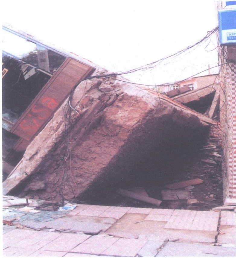
Şekil 3.7. Adapazarı'nda eğilme deformasyonu sonucunda bir bölümü açıkta kalan radye temel.
