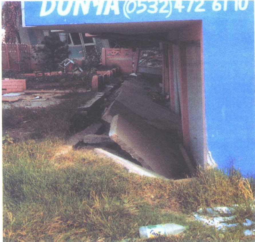
Şekil 3.6 Adapazarı'nda oturma formunda (yaklaşık 1m) aşırı temel deformasyonuna maruz kalmış bir bina.
