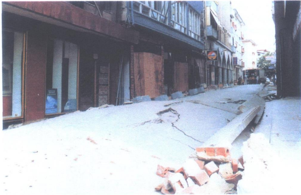
Şekil 3.11. Zemin deformasyonlarına bağlı olarak yol ve kaldırımlarda meydana gelen kabarmalar.
