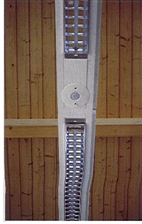
Şekil 3.59. BRE Binası - Yapay aydınlatma sistemi. (Wigginton, Harris, 2002)
