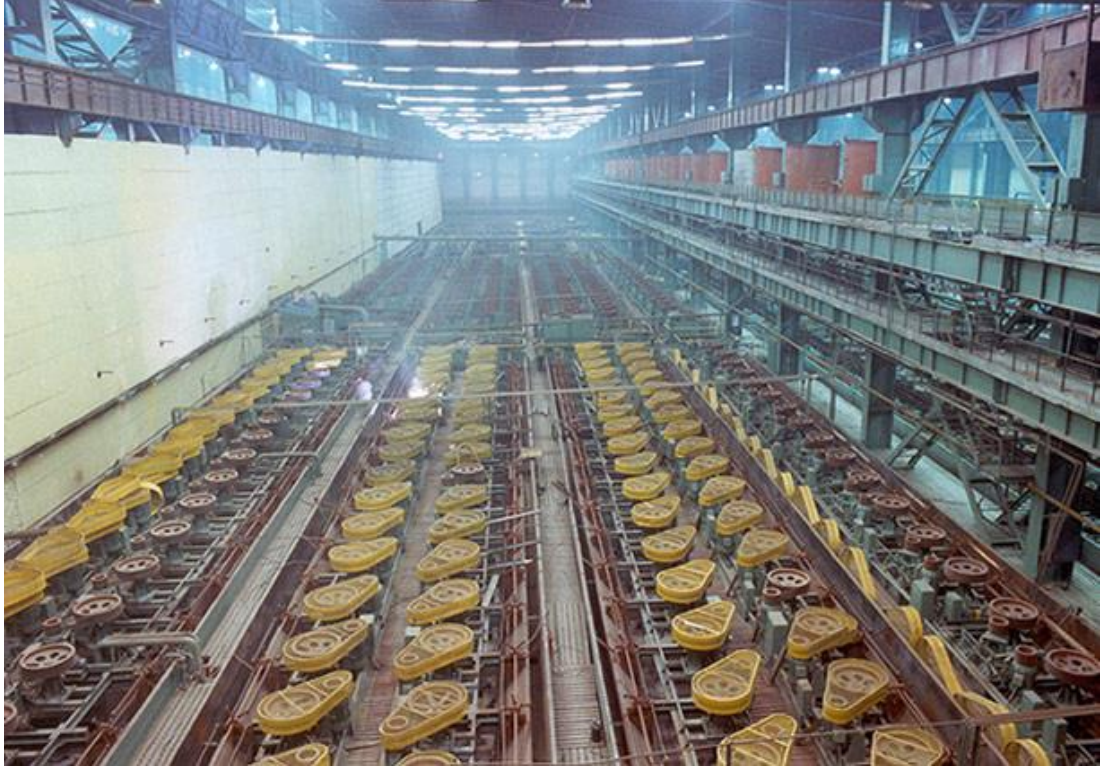
Şekil 2.7: Norilsk Madeni Flotasyon Tesisi
