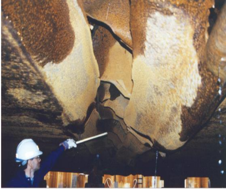
Şekil 5.9 : 117 ve 119 postalar arası enine perde dip kaplama hasarı.
