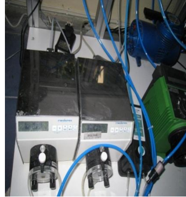
(j) Filtrasyon ve besleme pompaları
