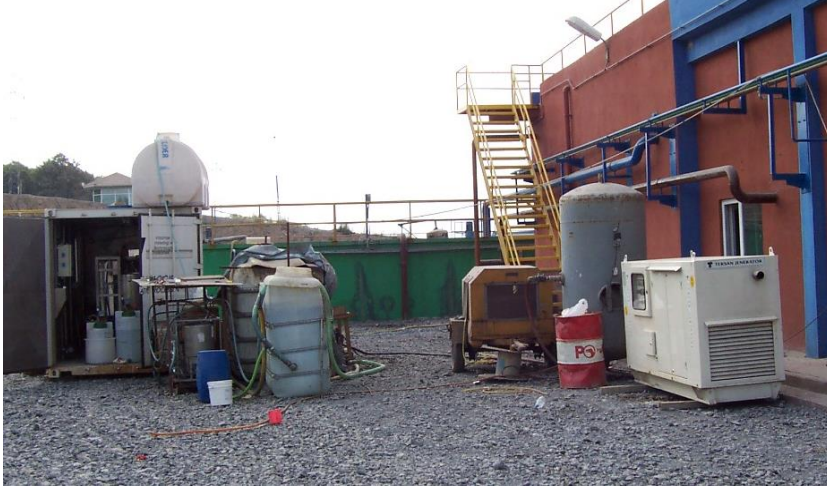
Şekil 5.2: Pilot tesis ve genel görünüş
