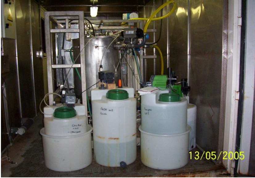
Şekil 5.4: Pilot tesis yandan görünüş
