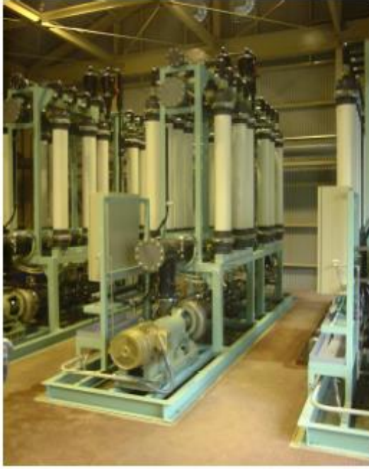
Şekil 4.6: Sasakura çöp sızıntı suyu arıtma tesisinde kurulan nanofiltrasyon üniteleri
