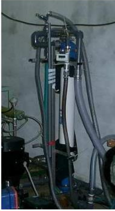
Şekil 4.5: Sasakura çöp sızıntı suyu arıtma tesisinde kurulan pilot nanofiltrasyon tesisi
