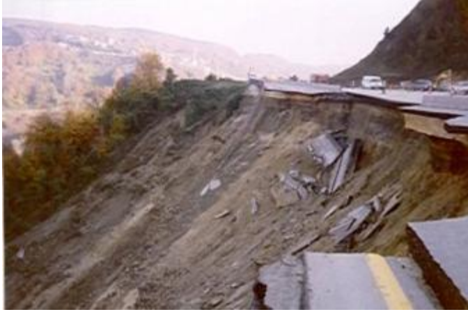
Şekil 4.4 : Düzce depremi sonrası E5 karayolunda meydana gelen toprak kayması [53].
