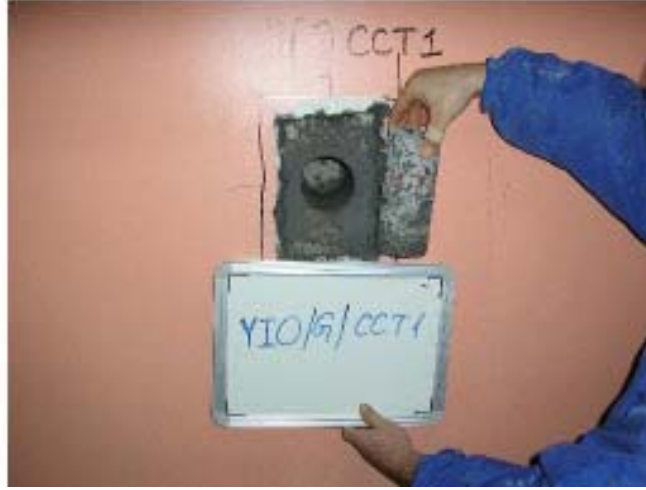
Şekil 7.4: Yapıya Ait Mevcut Beton Malzeme Dayanımının Öğrenilmesi Amacıyla Gerçekleştirilen Karot Deneyi
