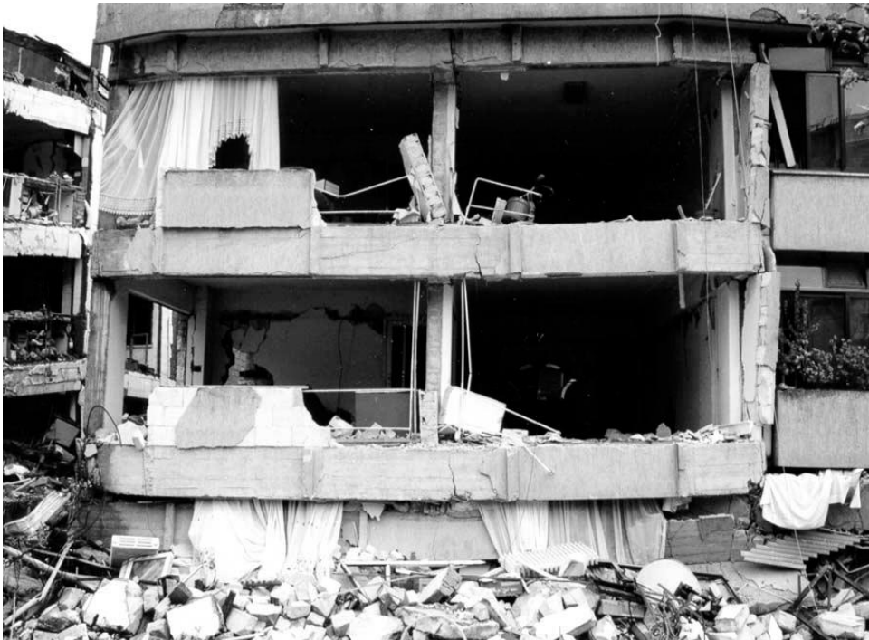
Şekil 2.14 Zayıf kolon güçlü kiriş etkilerinden kaynaklanan hasar
