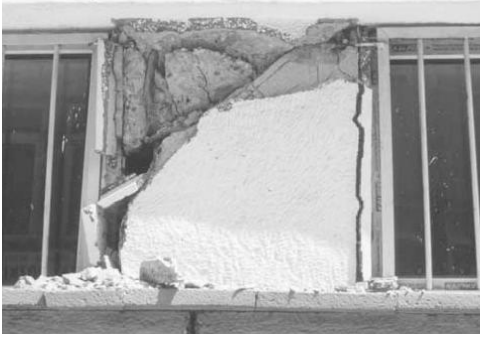
Şekil 2.13 Kısa kolon etkisinden kaynaklanan hasar
