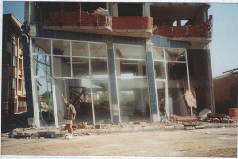
Şekil 4.3 : Adapazarı'nda 5 Katlı Binanın Zayıf Katında Hasar. (17 Ağustos 1999Kocaeli Depr. M=7.4) [34]
