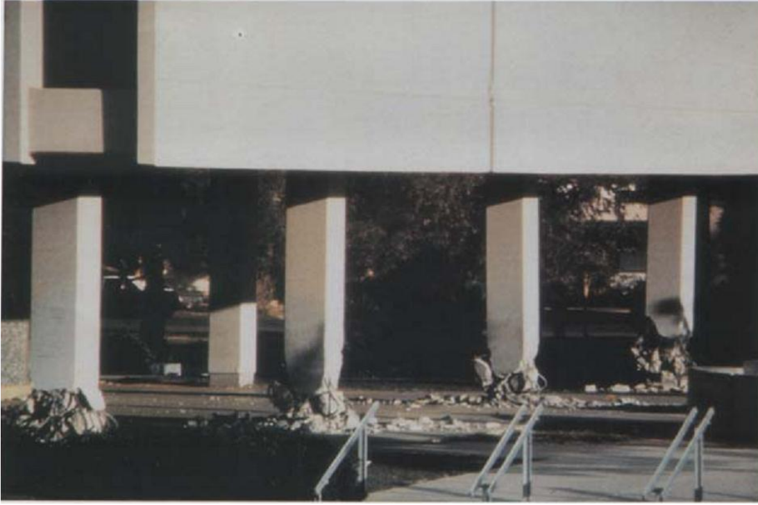
Şekil 4.5 : Imperial County Belediye Binası zayıf kat hasarı (15 Ekim 1979 Imperial County Depremi, M=6.4)[34]
