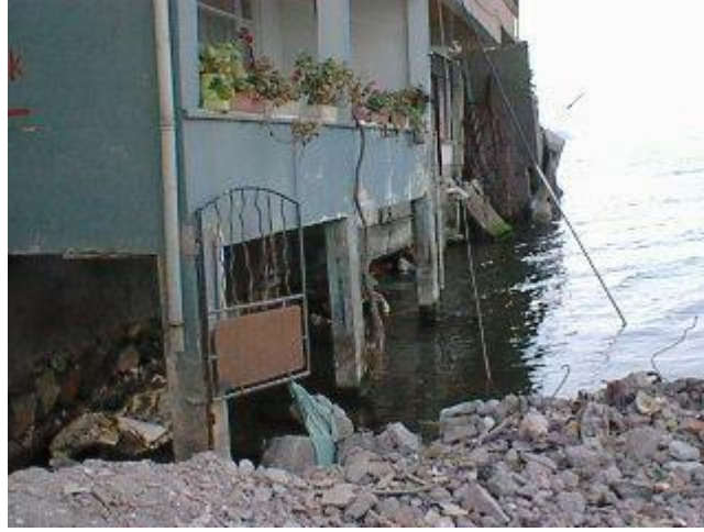
Şekil 2.5 : Kocaeli depreminde sahil kesimlerinde meydana gelen zemin sıvılaşması
