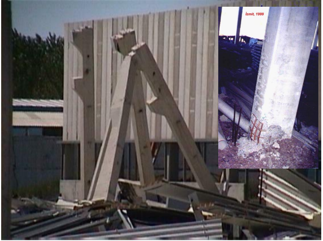
Şekil 2.3 : Kocaeli depreminde hasar gören prefabrike bir yapı
