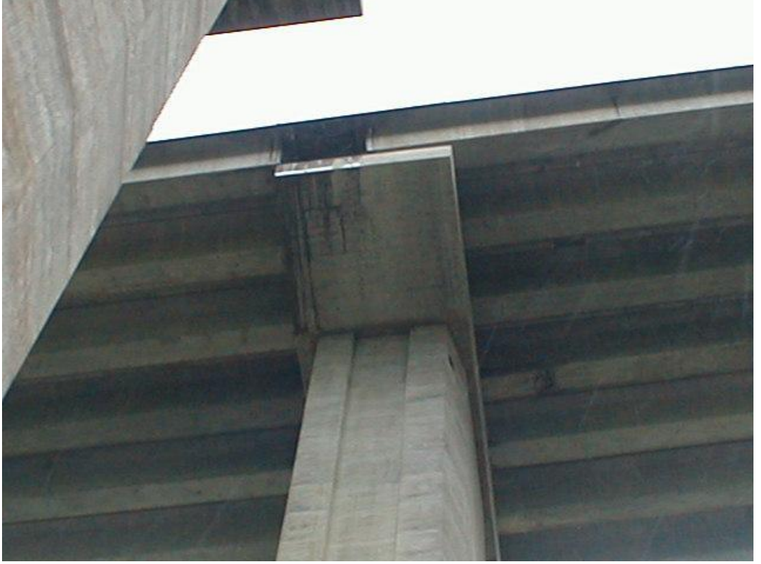
Şekil 2.13 : Düzce depreminde hasar gören bir viyadük
