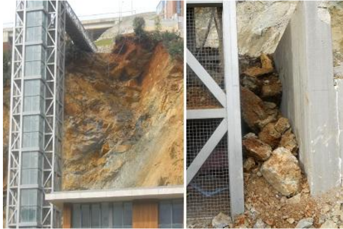
Şekil 2.4: Asansör merdiven kovasını ve girişini dolduran heyelan malzemesi
