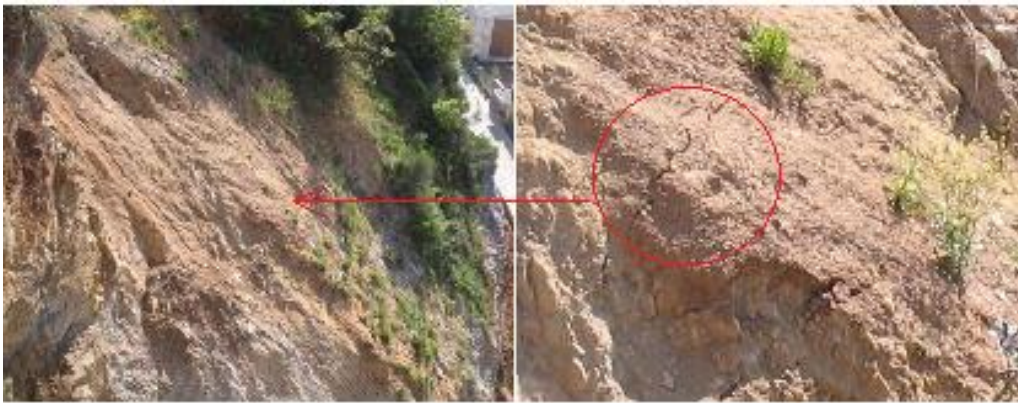
Şekil 4.13: Toprak akması sebebiyle şev yüzeyinde oluşan çizgiler
