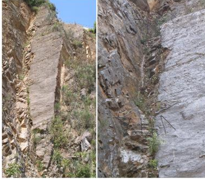
Şekil 4.27: Taş düşmelerini engellemek için yapılan uygulama
