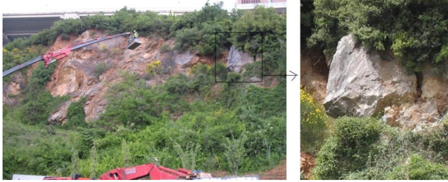
Şekil 7.33: Serbest bloğun uygulama öncesindeki durumu
