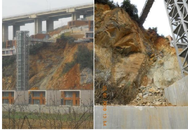
Şekil 2.5: Asansör bölgesinde desteksiz bırakılan kaya şevinde oluşan kaya kaymaları
