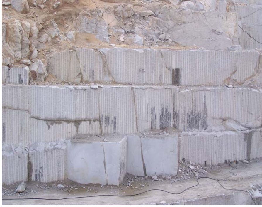
Şekil 3.23: Üretim aynalarında gözlenen çatlaklar.
