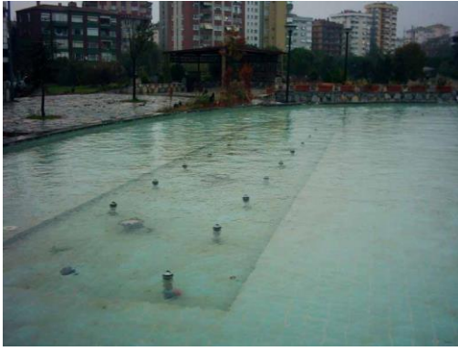
Şekil 5.20: Güney girişindeki havuzda yer alan projektörler
