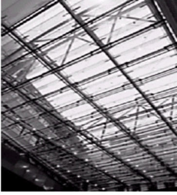
Şekil 3-54: Rewe Merkezi’ndeki holografik saydam gölgeleme sisteminin yer aldığı çatı ışıklılığındaki hareketli elemanlarının içeriden görünüşü [3].
