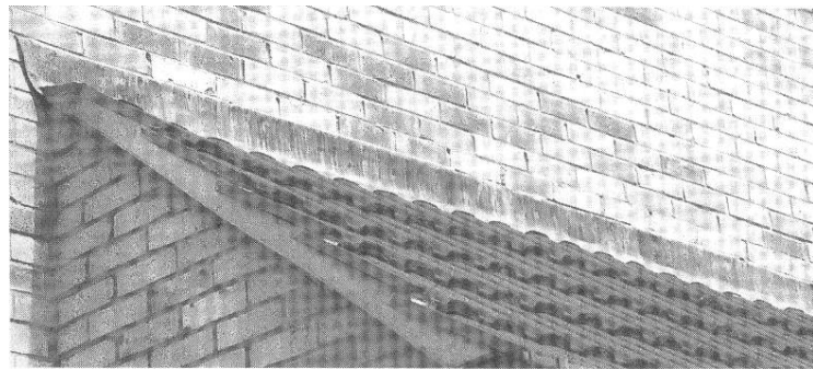
Şekil 4.2 Harcın metalde yol açtığı korozyon [30]
