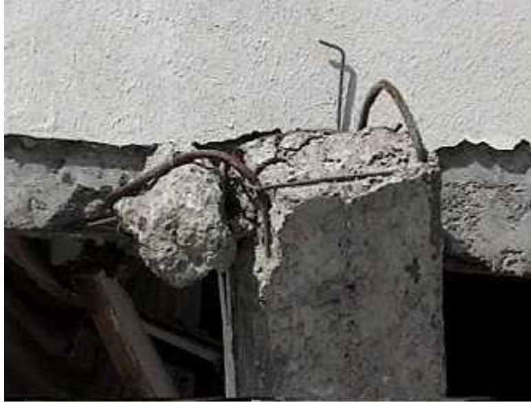
Şekil 2.14 Yetersiz donatı kullanımı sonucu kolonun kirişten ayrılması [24].
