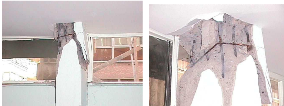
Şekil 2.13 Taşıyıcılarda eksik ve yanlış donatı kullanımı, kısa kolon etkisi [24].
