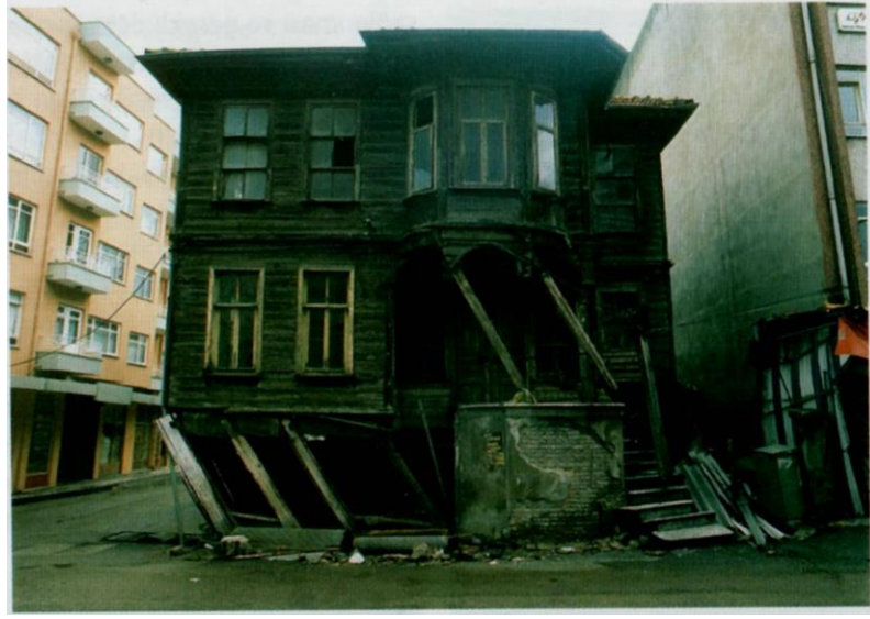
Şekil 3.11 Ahşap iskeletli binada yumuşak kat oluşumu (Adapazarı) [18].
