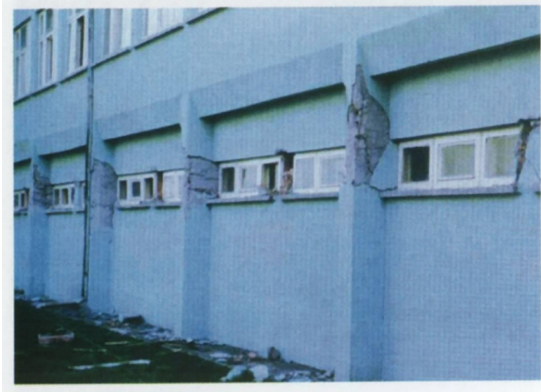
Şekil 3.19 Bant pencerelerden kaynaklanan kısa kolon hasarı [18].
