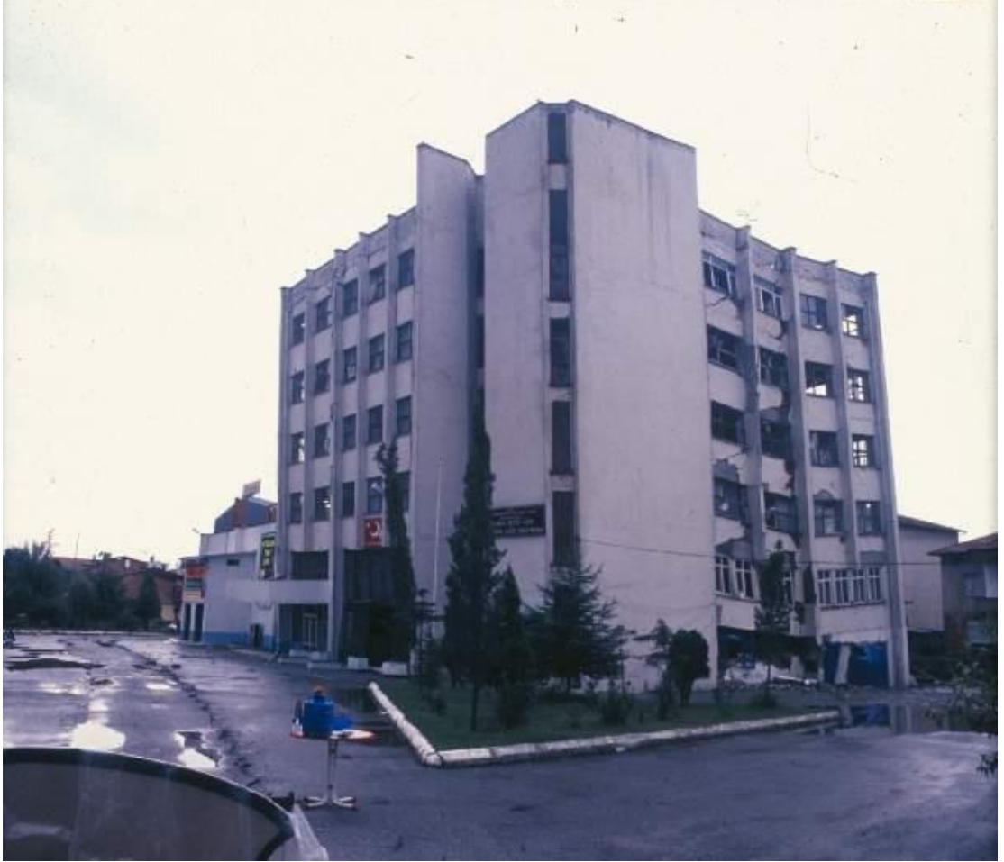
Şekil 2.17 Çekirdeği köşede yer alan bir binada burulma hasarı [17].
