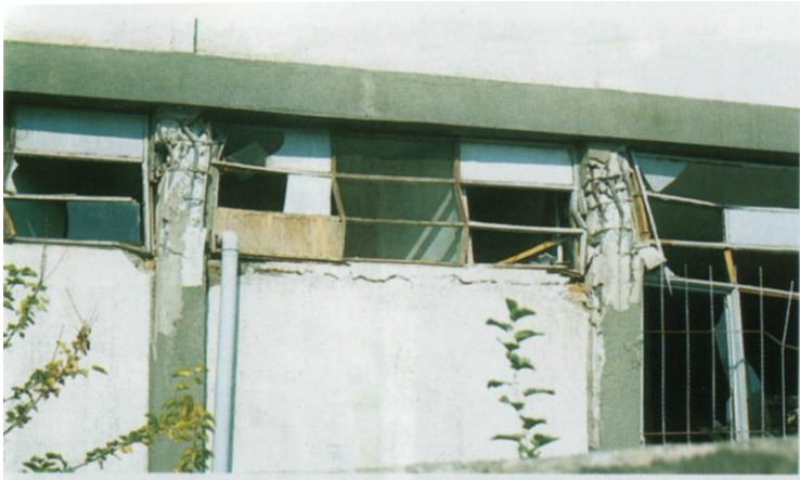
Şekil 3.20 Kısa kolon etkisi [18]
