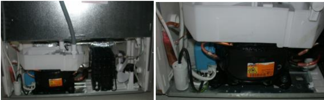
Şekil 2.90: NM1 kompresör bölgesinin görünüşü.
