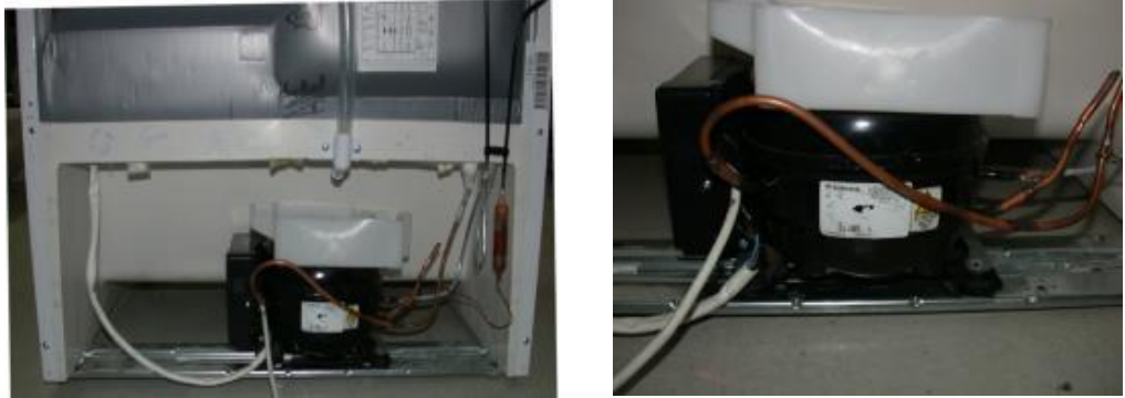
Şekil 2.108: NM3 kompresör bölgesinin görünüşü.
