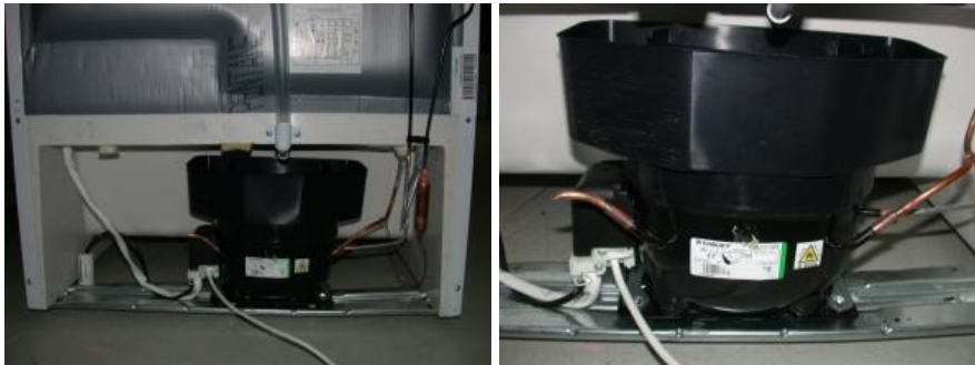
Şekil 2.98: NM2 kompresör bölgesinin görünüşü.
