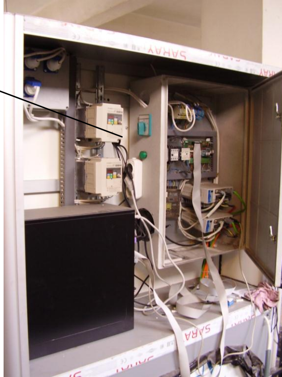
Şekil 3.24 : Spindle motor sürücüsü ve pano uygulaması
