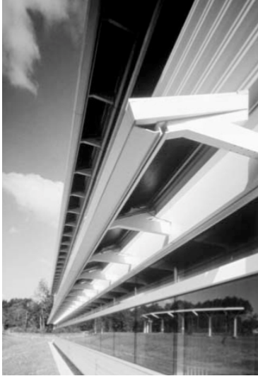
Şekil 3.20: Güneş pili panelleriyle güneş kırıcı uygulaması
