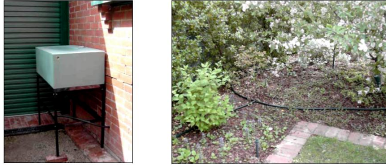
Şekil 5.10 : Çamaşır makinasından çıkan gri suyun bahçe sulamasında kullanılması
