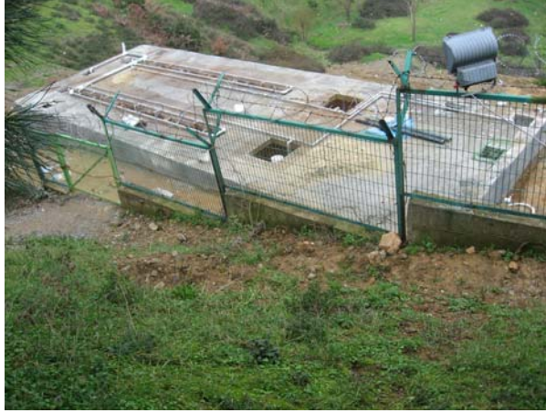
Şekil 5.21 : Yeşilyamaç Sitesi biyolojik atıksu arıtma tesisi
