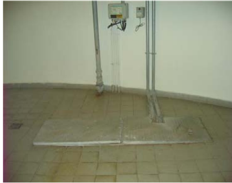
Şekil 5.19 : Arıtılmış fazla su tankı
