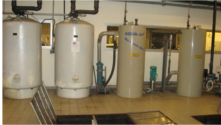
Şekil 5.17 : Yağmur suyu ile arıtılmış gri suyun karıştırılarak araç yıkamada kullanılması
