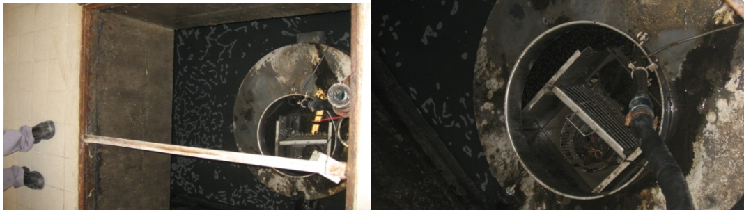
Şekil 5.15 : 2. tank ve yağ ayırıcı filtreler
