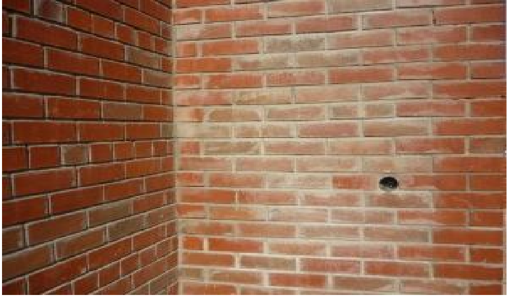
Şekil 4.6 : Örnek konut hava tabakalı tuğla duvarlarda tuzlanma
