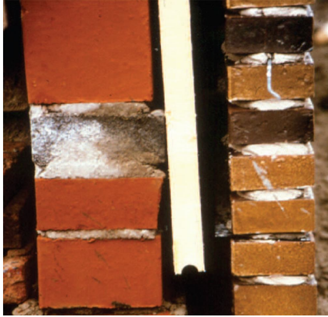
Şekil 3.13 : Yanlış uygulanmış yalıtımlı hava tabakalı duvar [8].
