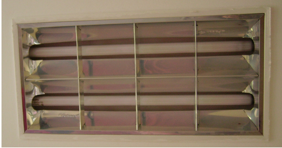
Şekil 5.28: Hasta Yatak Odasındaki Genel Aydınlatma Aygıtları
