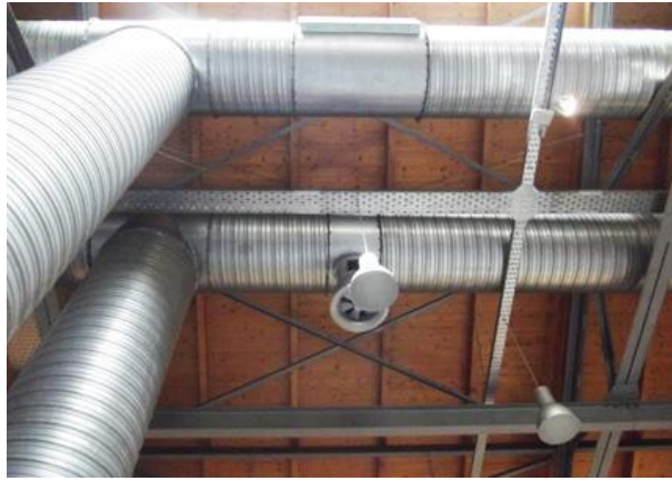
Şekil 5.56 : Elektrik tavalarına monte edilmiş sarkıt aygıtlar, (Sezer, S., 2013).
