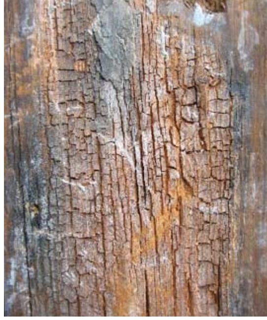
Şekil 4.4. Ahşabın çürümesine örnek [34].
