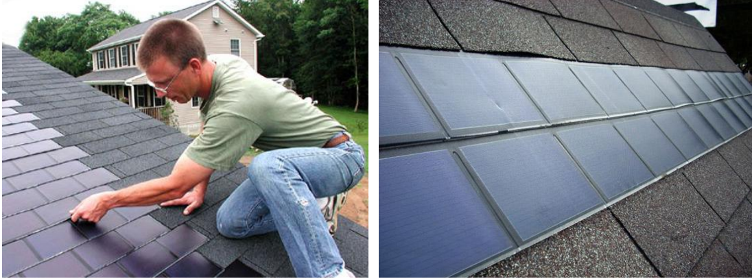
Şekil 3.24 : Çatıda şingil PV kullanımı [48]
