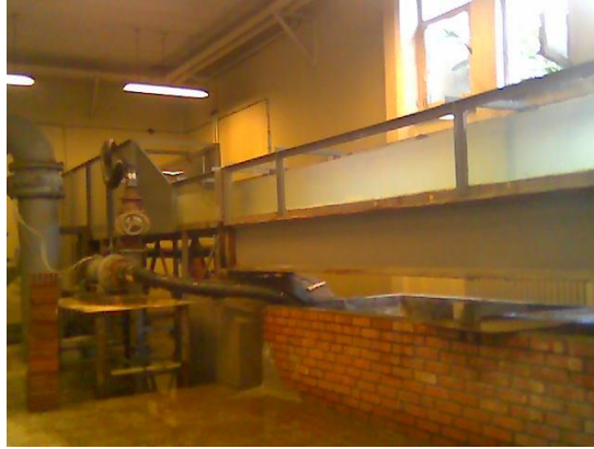
Şekil 3.1 Deneyin yapıldığı Açık kanalının membasının ve Pompanın Gösterimi
