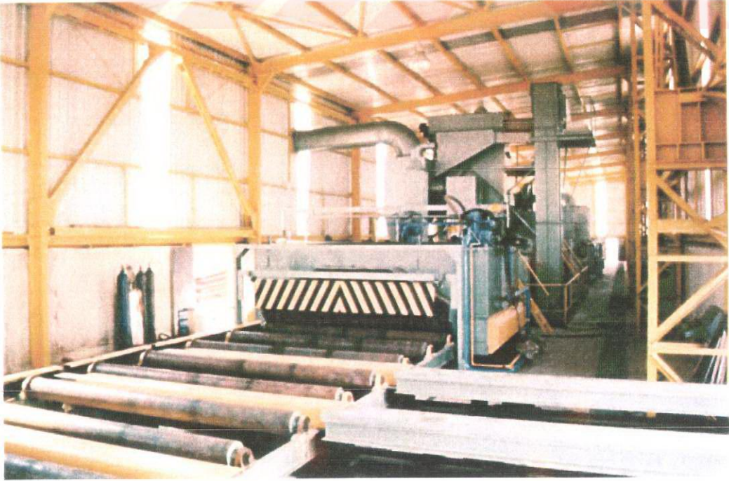
Şekil A.6: Sac-profil kumlama, boyama tesisi
