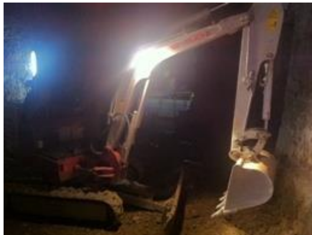
Şekil 6.6: Risk Değerlendirmesinin yapıldığı ekskavatör.
