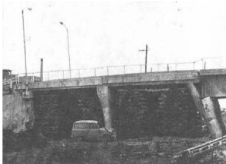
Şekil 5.3: Yachiyo Köprüsünün Yapısal Hasarı (Hamada, 1992a)
