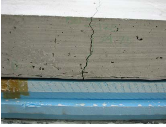
Şekil 7.5: P11 Plagi 3A Çatlağı
