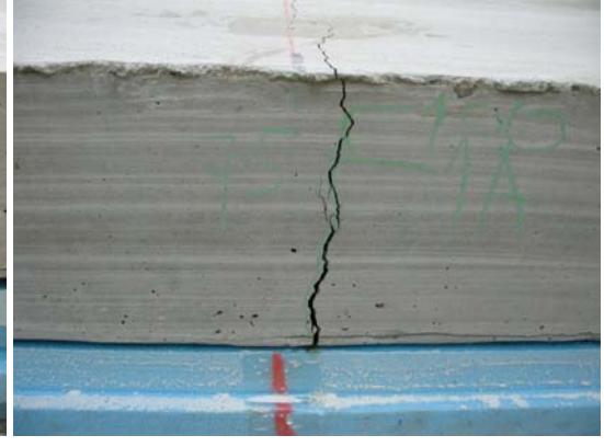
Şekil 7.6: P11 Plagi 1A Çatlağı
